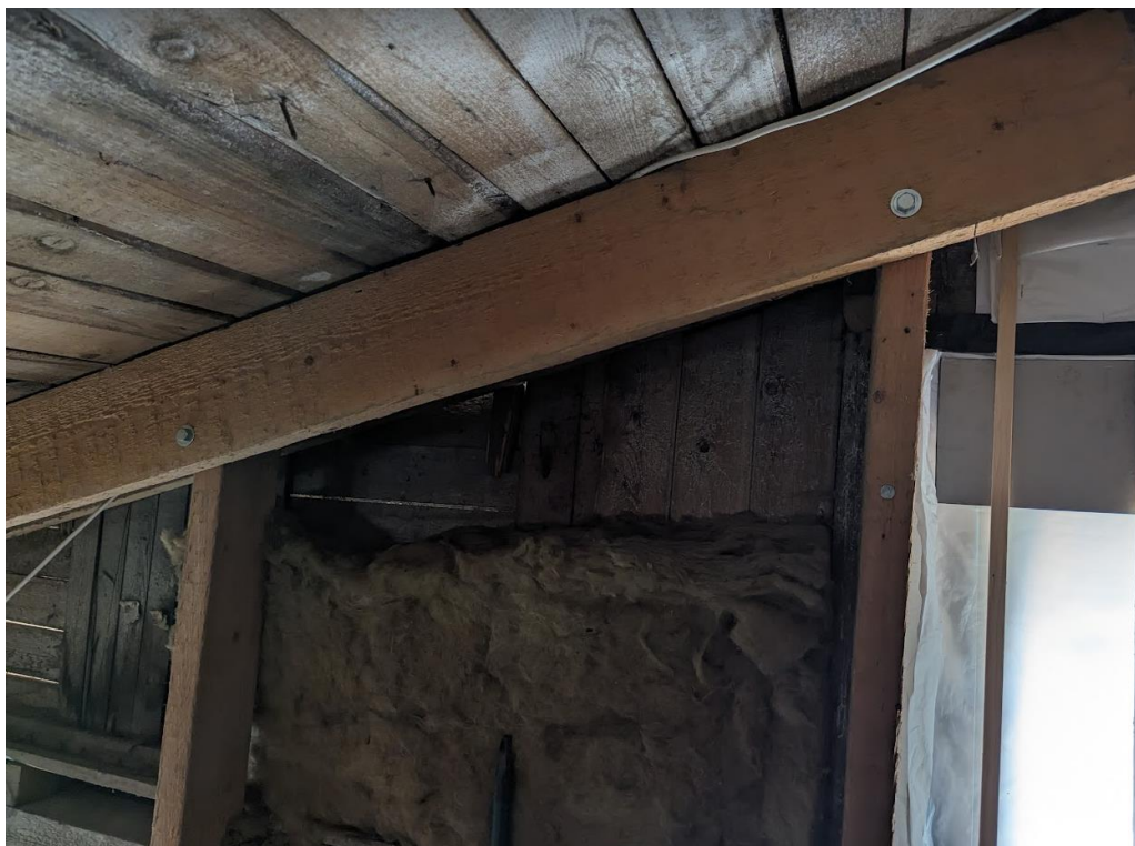
Foto 36. Pööningu kandekonstruksiooni tugevdused.
