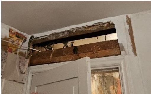
Foto 22. Siseseina konstruktsioon keldrikorruse kunagises korteris.
