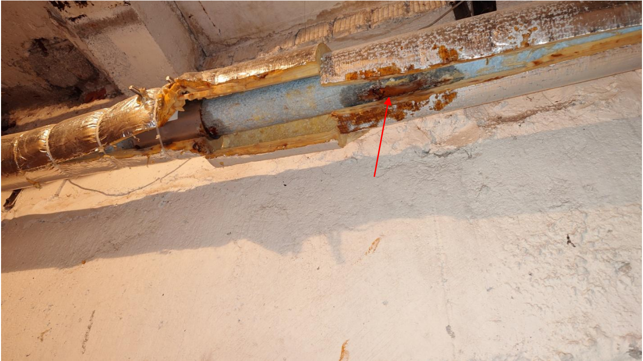
Pilt 14 Külma tarbevee torustik korrodeerunud. Avariiline lekkekoht.
