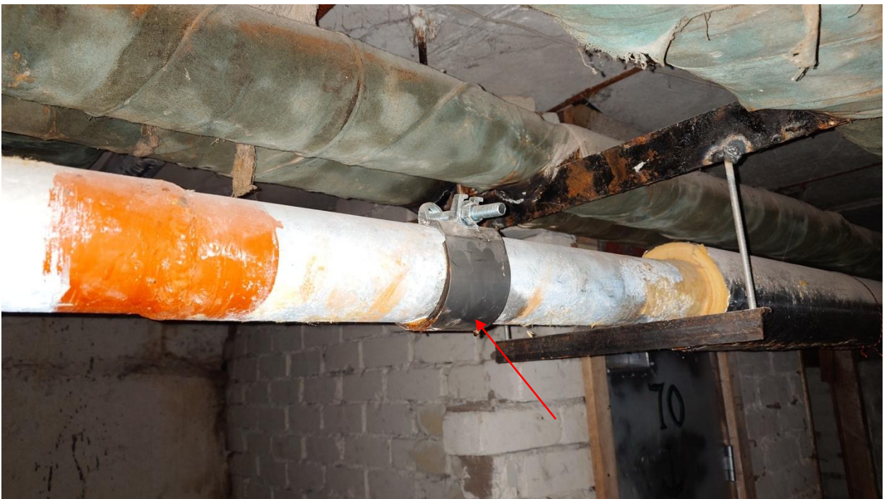
Pilt 13 Külma tarbevee torustik korrodeerunud. Lekkekoht parandatud bandaažiga.
