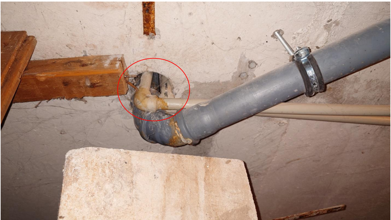
Pilt 15 Torude läbiviik tuletõkke tsoonist ei vasta nõuetele. Lekked.
