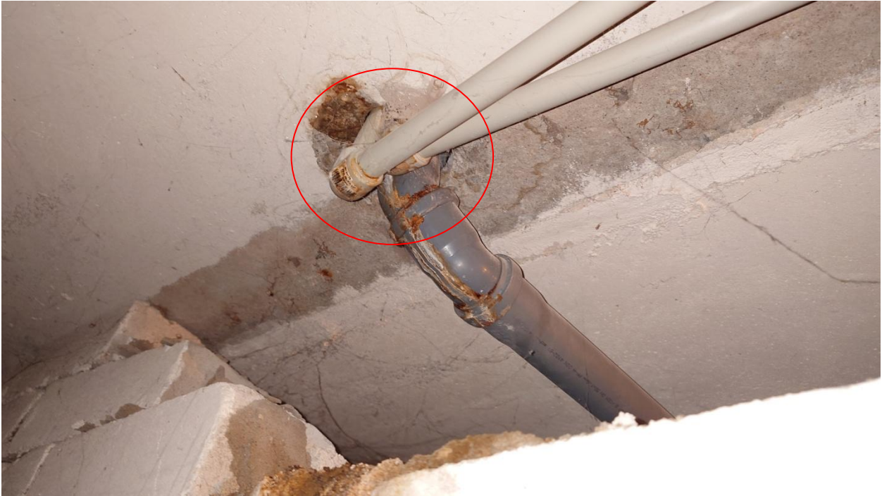
Pilt 16 Torude läbiviik tuletõkke tsoonist ei vasta nõuetele. Lekked.
