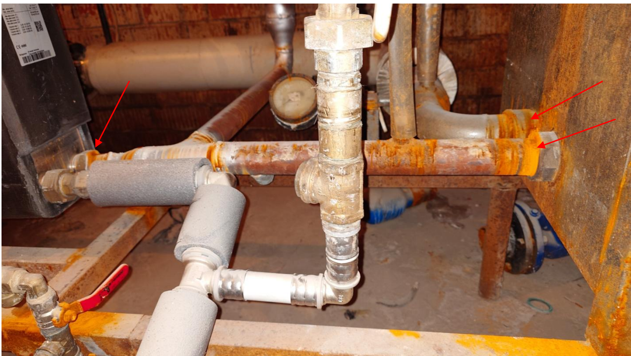
Pilt 5 Soojusvahetite ühendustel lekked ja korrosioon. Kaitseklappi ees ei tohi olla sulgarmatuuri.
