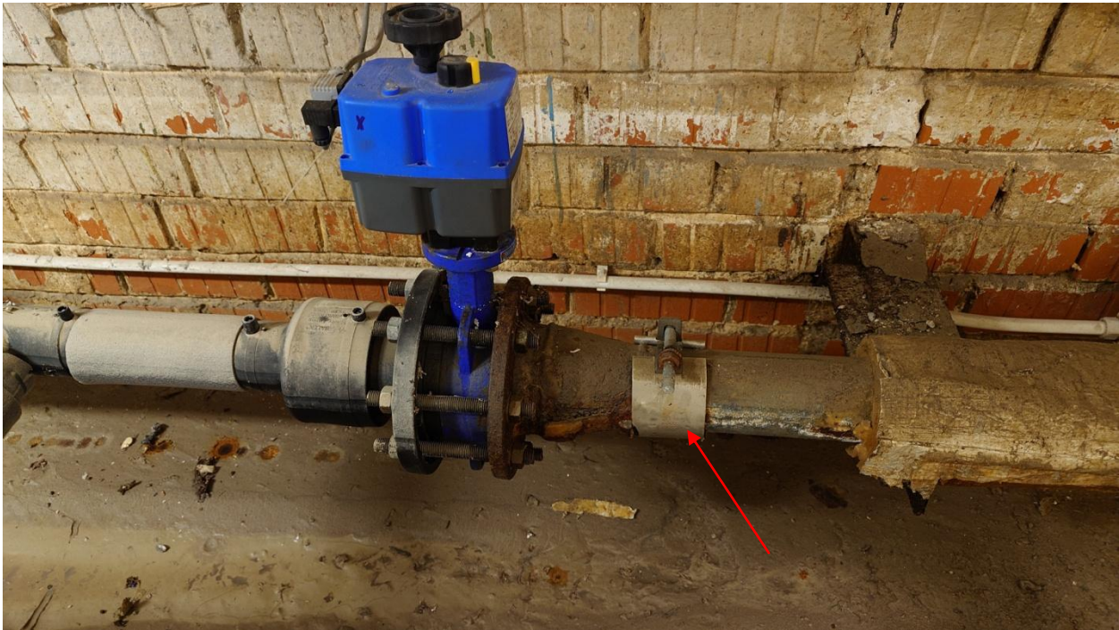
Pilt 10 Tuletõrjehüdrantide veevarustus torustik korrodeerunud. Lekkekoht parandatud bandaažiga.
