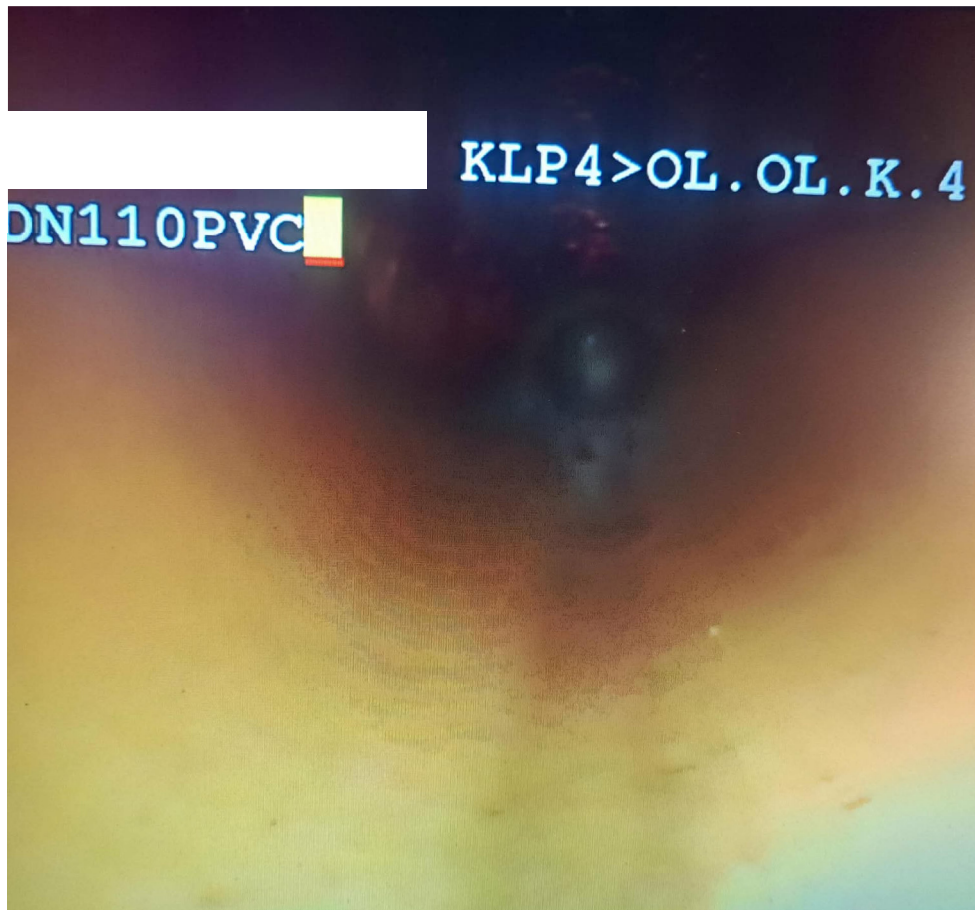
Foto liitumispunktist suunaga peatorustiku poole
