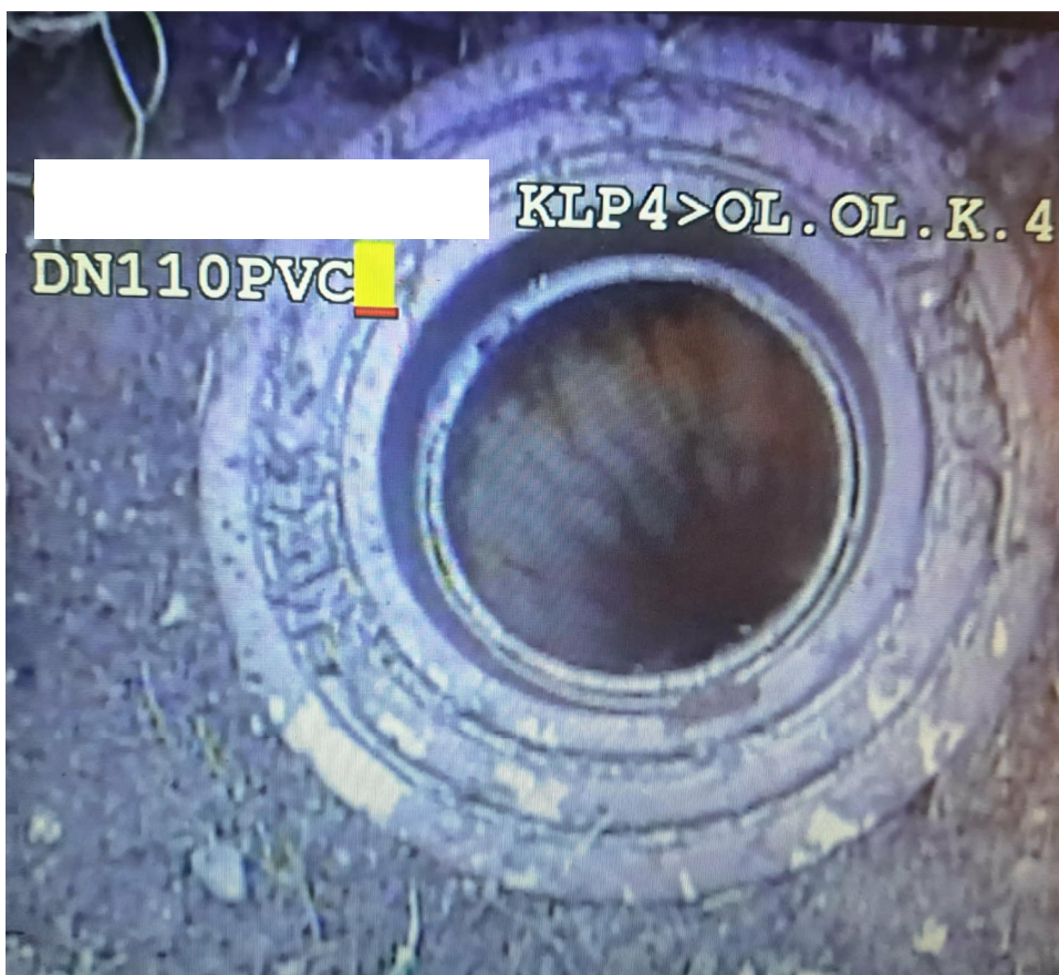
Foto liitumispunktile (kontrollkolmikule 2-KT50-04)
