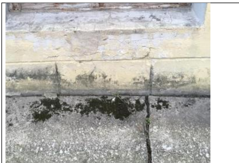
Astmeplaatide täpsed mõõdud kontrollida peale katkiste astmete eemaldamist Kedritrepp
