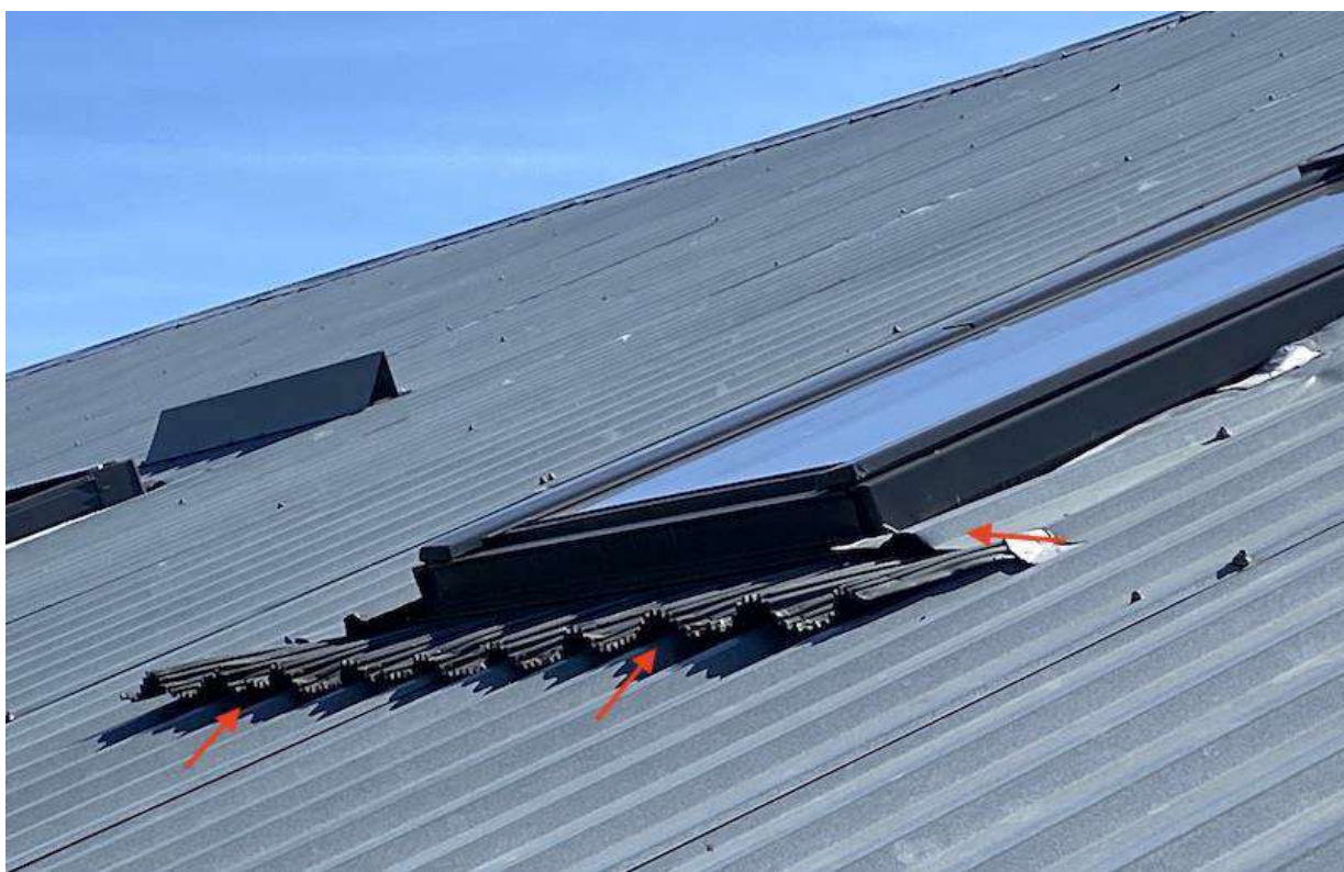
Foto 27. Katuseakende ümber esineb ebatihedusi, lahtist katuseplekki, avatud kruviauke, katkiseid tihendeid.
