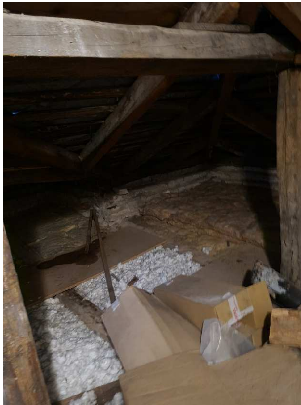
Foto 7. Katuse lekkekoht, pildistatud pööningult.
