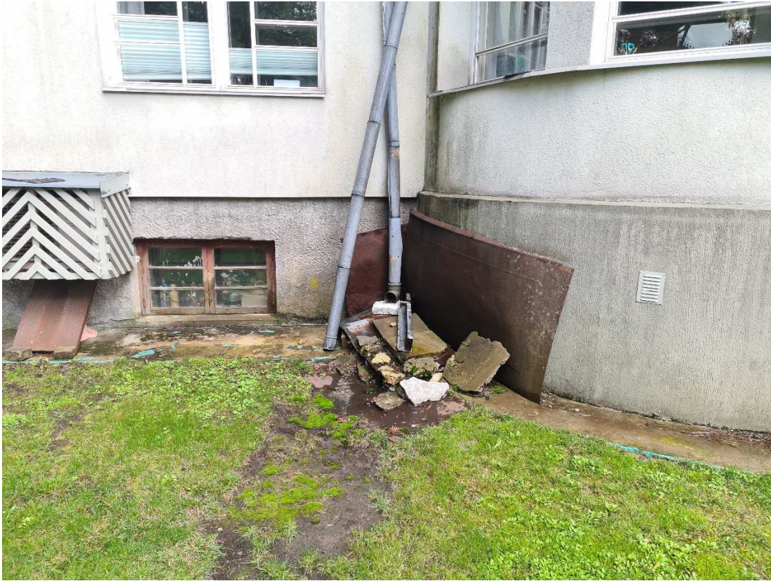
Foto 15. Vihmaveetoru alumine osa. Käepärastest materjalidest on ehitatud sadevee hoonest eemale juhtimise „süsteem“
