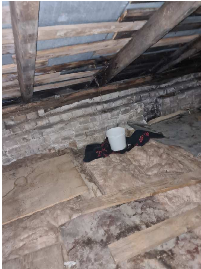
Foto 6. Katuse lekkekoht, pildistatud pööningult.
