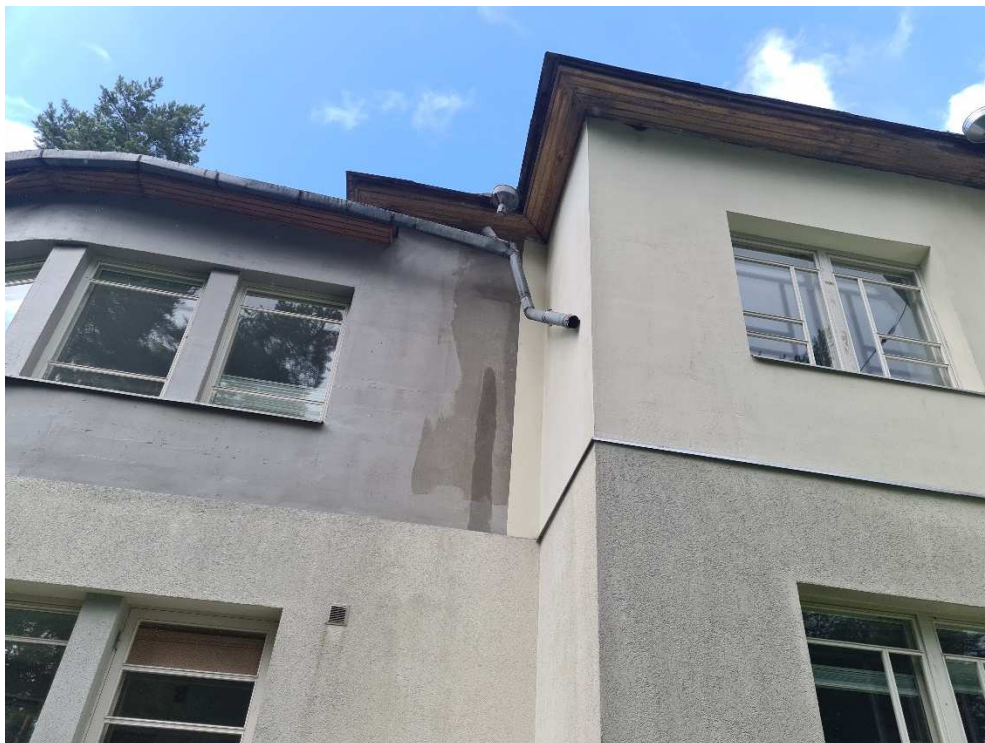
Foto 14. Ära kukkunud vihmavetoru. Ülemise korruse sein on märgunud
