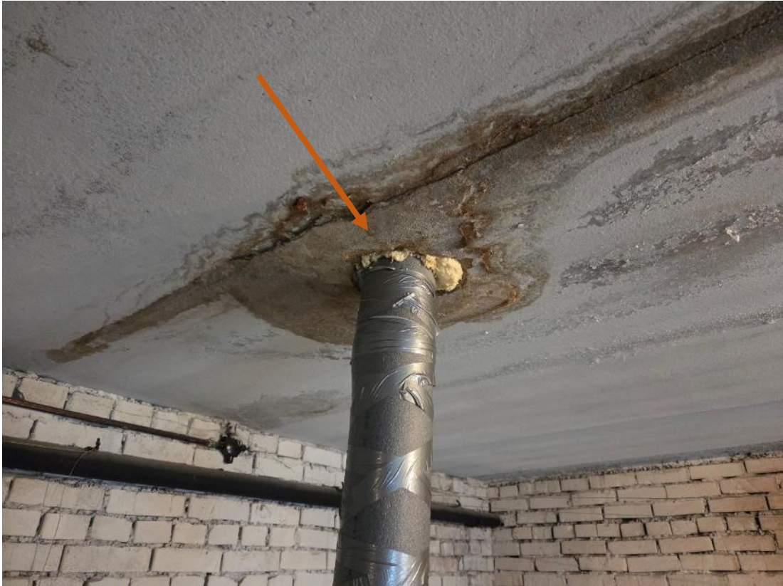
Foto 53. Läbiviigu juures on näha varasemat niiskuskahjustust. Kontrollida läbiviiku katusest rekonstrueerimise käigus.
