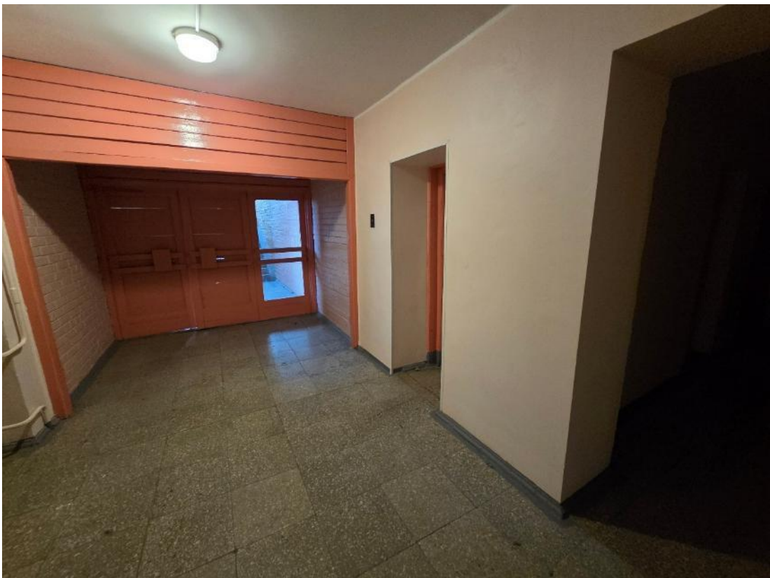
Foto 40. Sissepääs hoonesse on heas seisukorras, siseviimistlus on vananenud.
