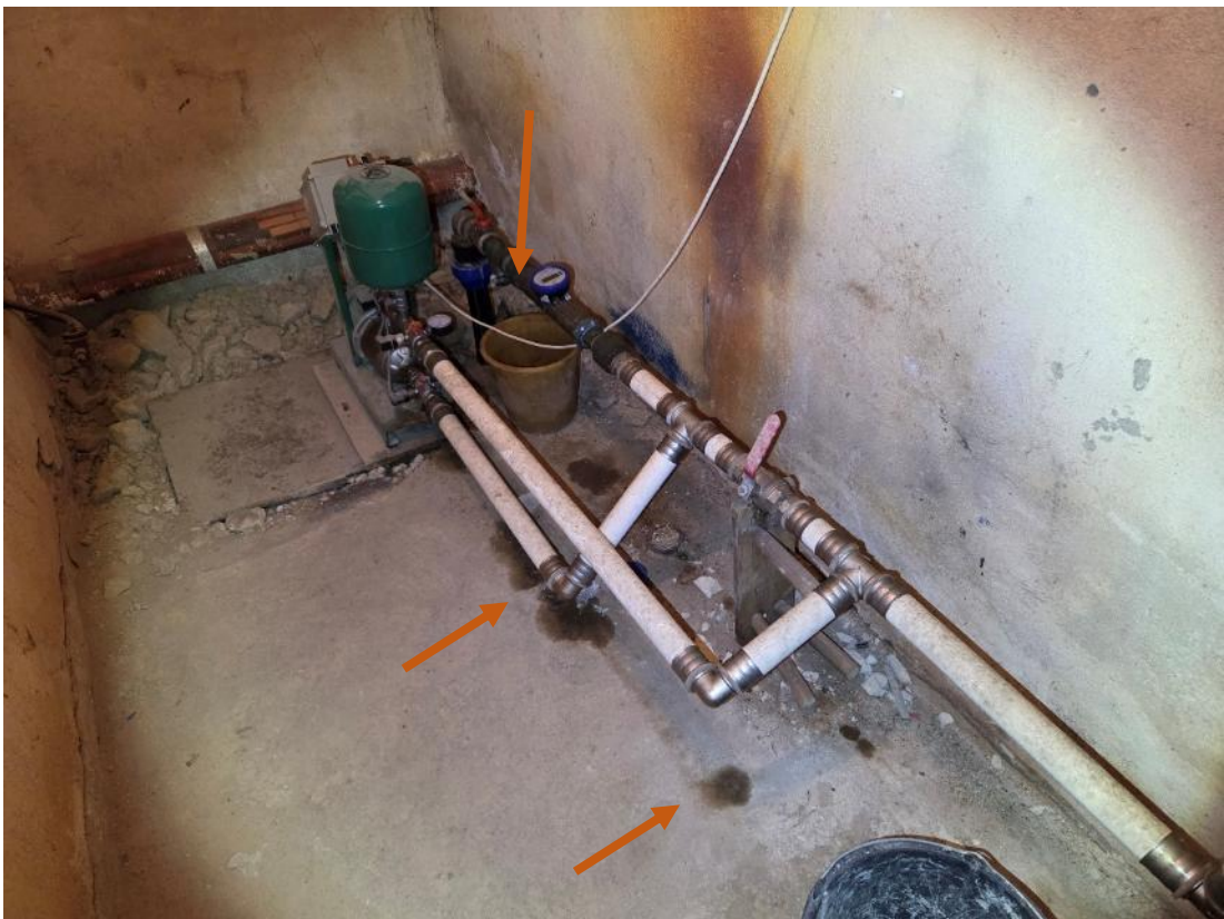
Foto 18. Veemõõdukõlme all on ämber – torustik isoleerimata, näha on niiskeid kohti põrandal.
