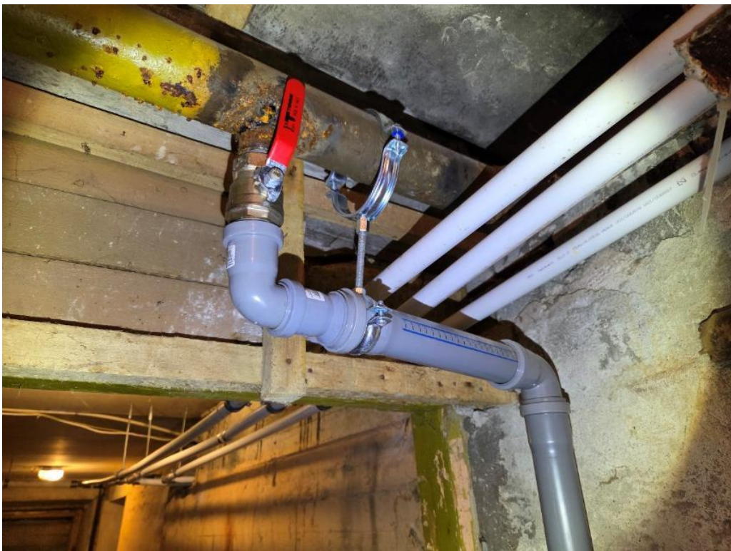
Foto 26. Arusaamatu lahendus kanalisatsioonitorusikul, paigaldatud kraan kanalisatsioonitorule.
