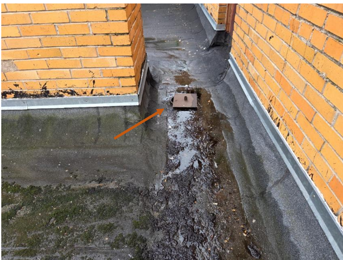
Foto 60. Vihmavee äravool on kõrgemalt kui katus ise ning kaetud teraskattega – ilmastikuvee äravool ei ole tagatud.
