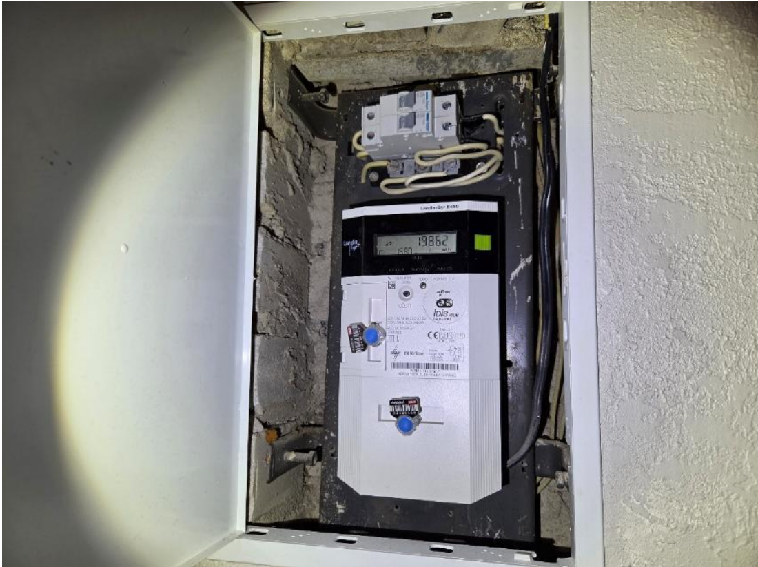
Foto 65. Elektriikaabeldus on enamjaolt hoone ehitusaegne.
