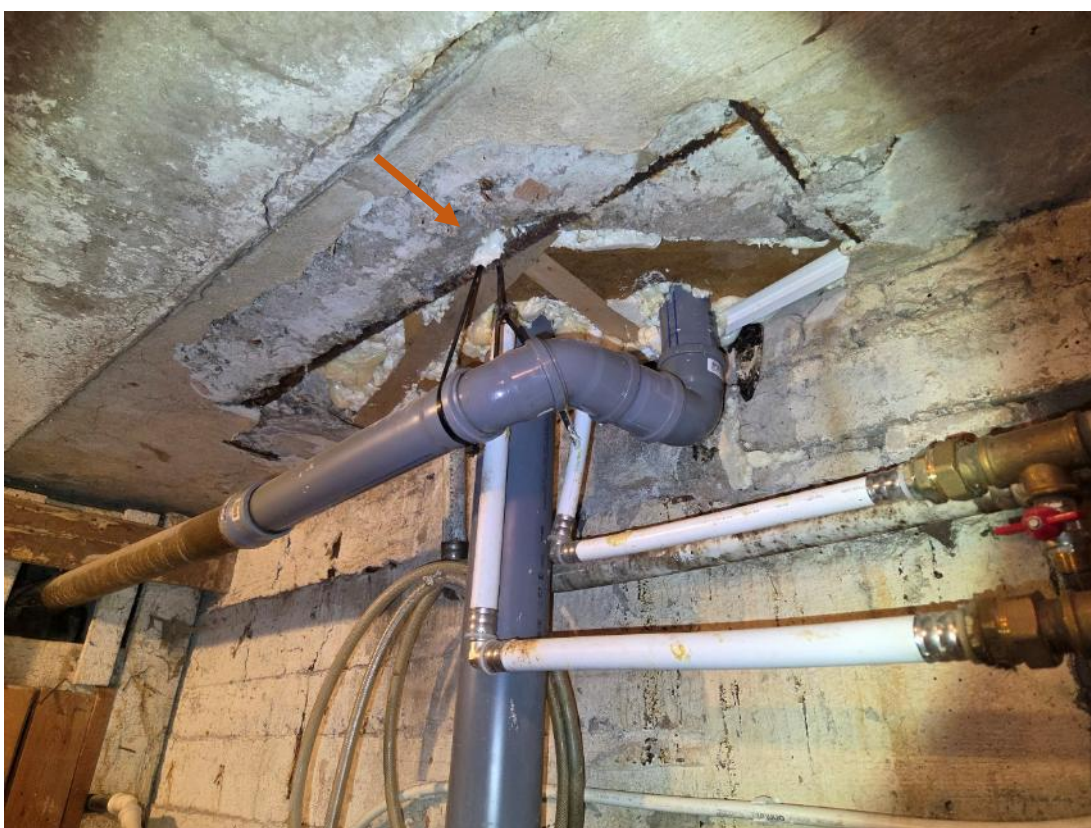
Foto 28. Vaheviigul puuduvad tuletõkkemansetid, paigaldatud vaht ei taga tuletõkkeseksiooni.
