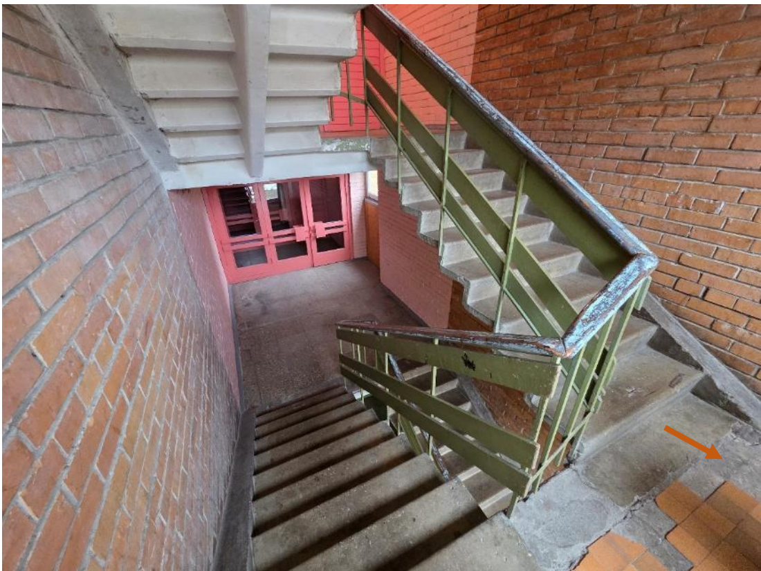
Foto 38. Trepikoda on heas seisukorra, siseviimistlus on vananenud, keraamiline plaat põrandal on osaliselt lahti tulnud.
