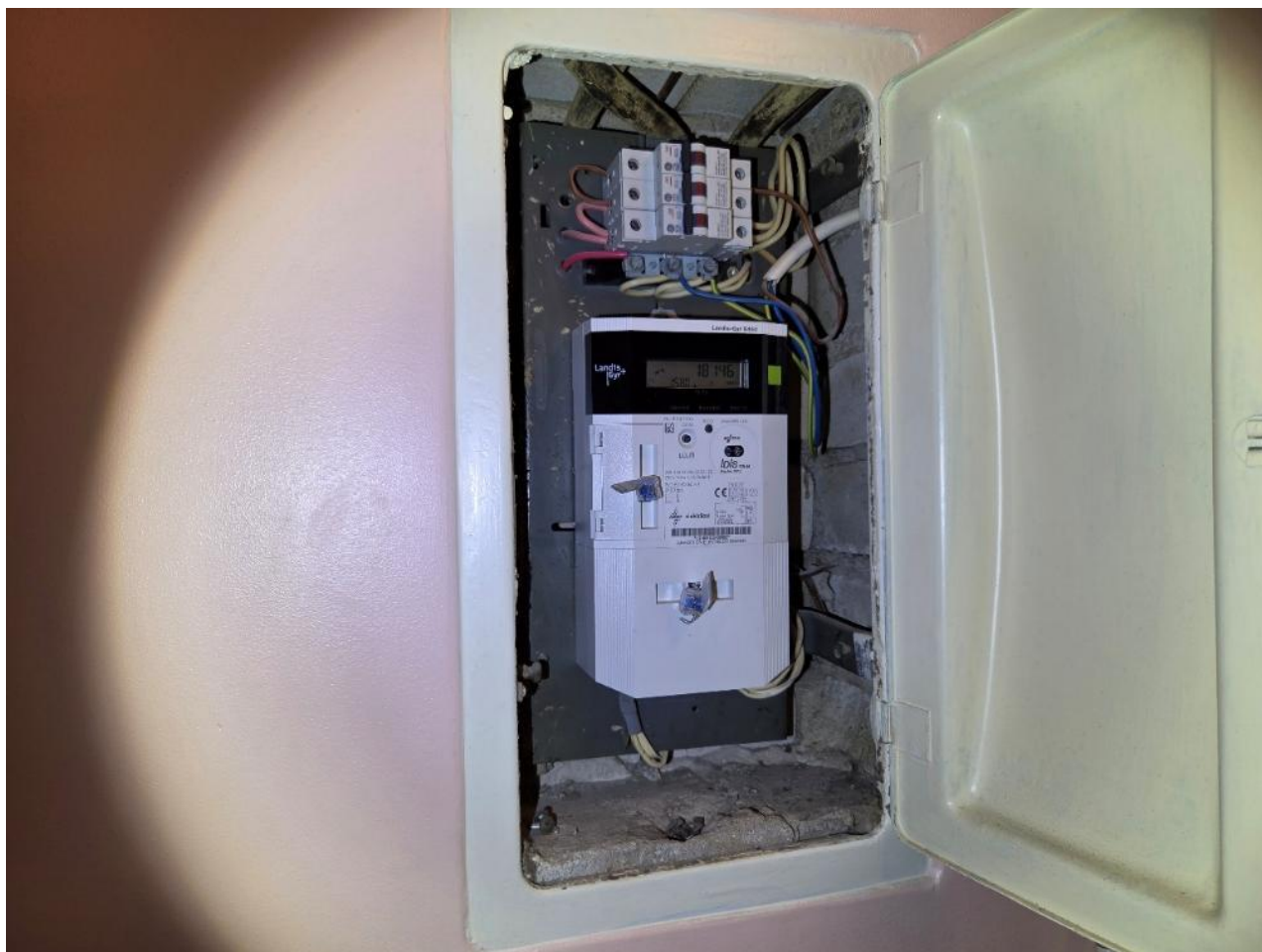
Foto 73. Osaliselt on säilinud vana elektrikaabeldus.
