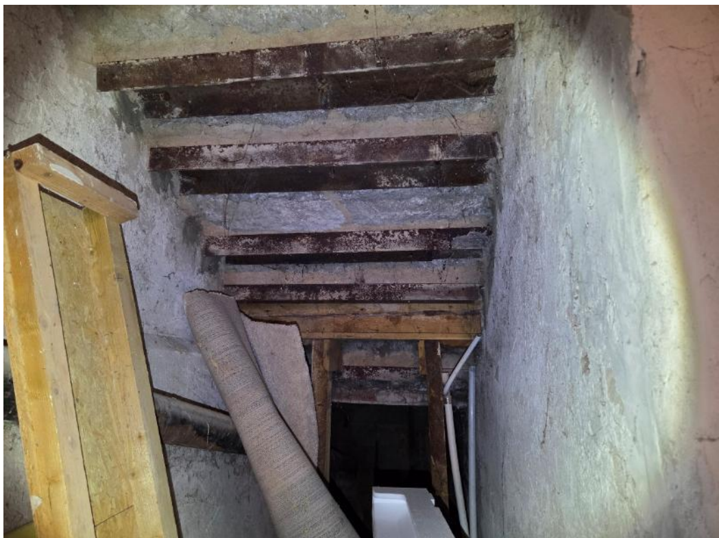
Foto 16. Keldrikorruse trepialune, teraselemendid puhastada ja katta korrosioonikaitsega.
