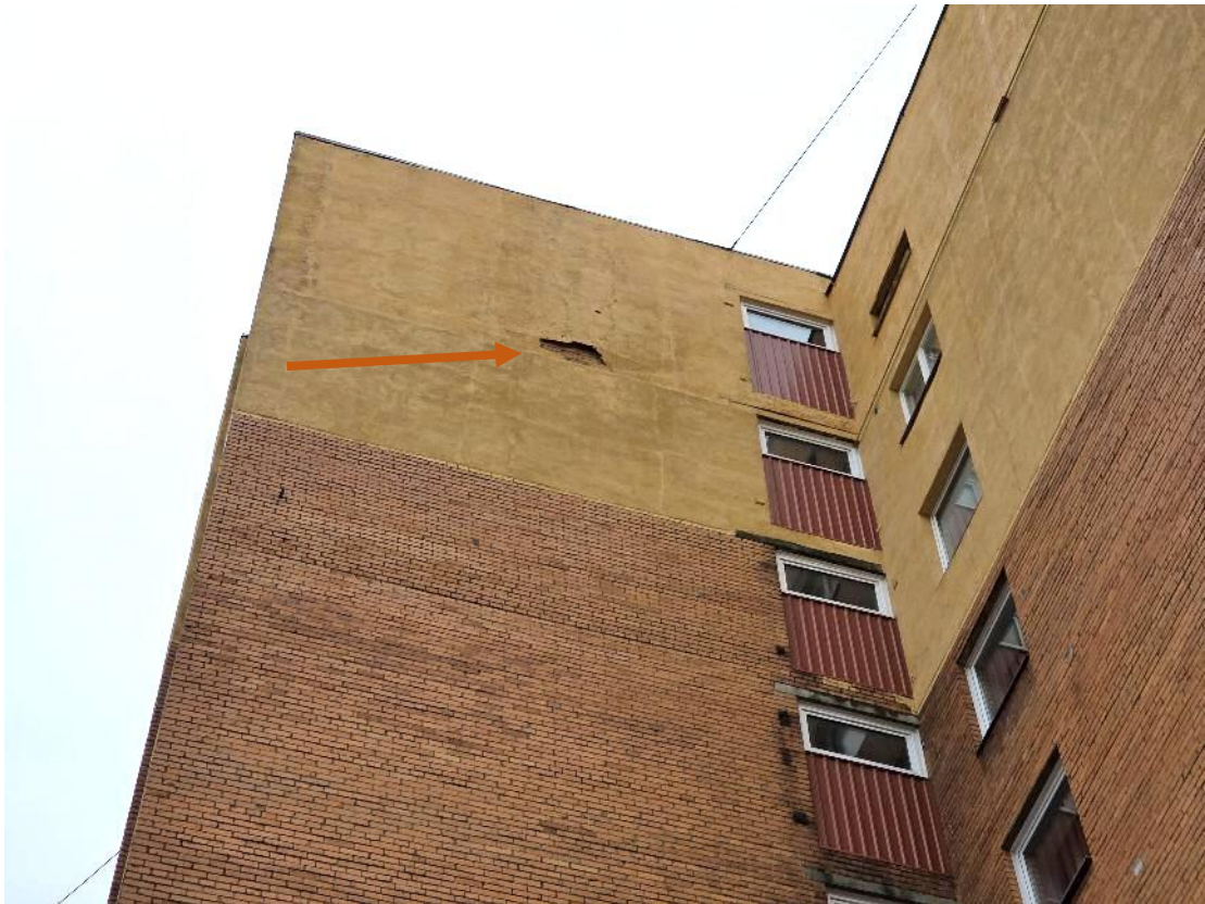
Foto 11. Krohv viimastel korrustel on lahti ja osaliselt alla kukkunud.
