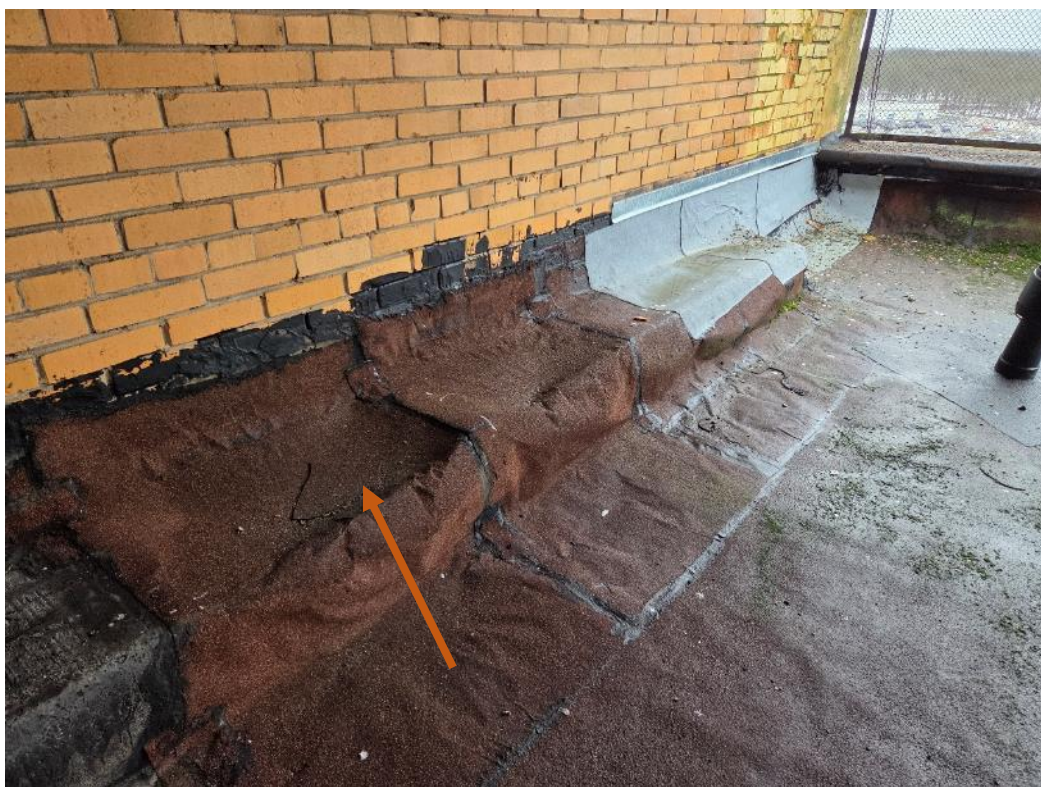
Foto 56. Lohud on liiga suured, vee kogunemise võimalus.
