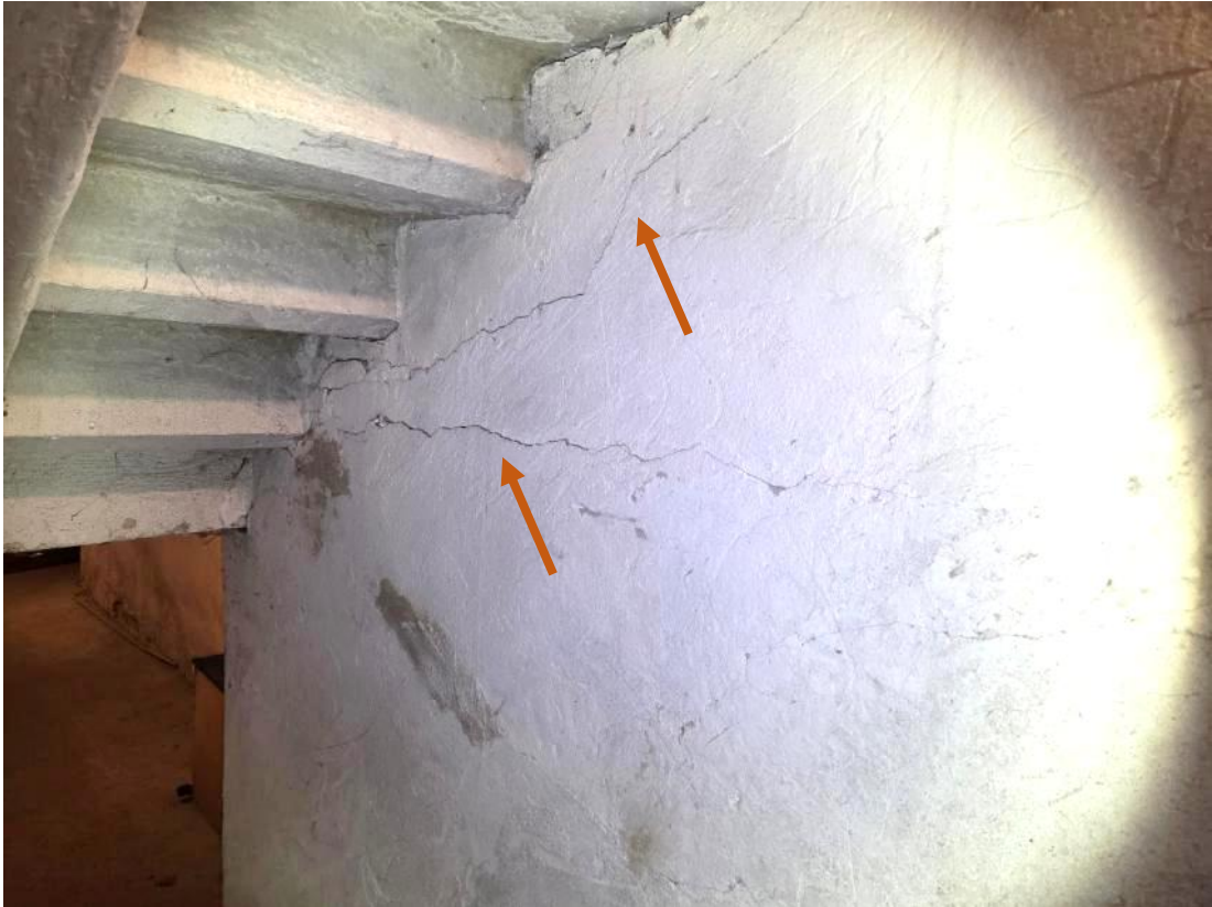
Foto 31. Keldrikorruse trepi all on praod – võtta kuni renoveerimiseni jälgimise alla.
