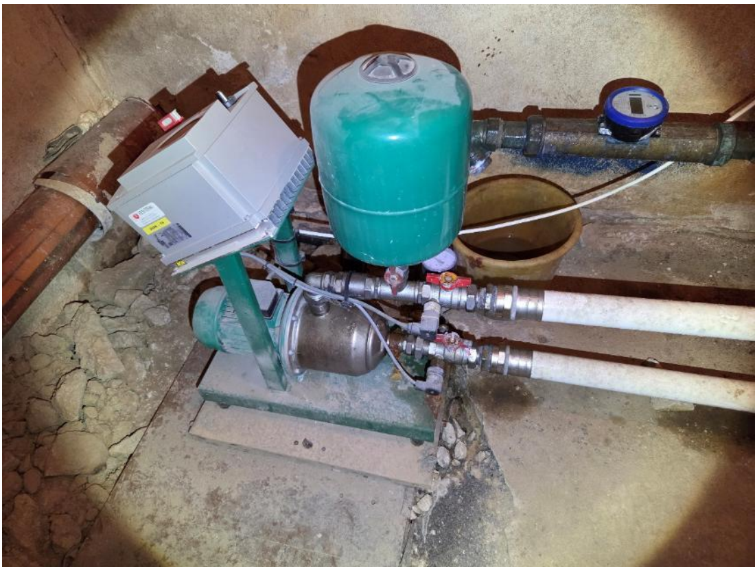
Foto 20. Veemõõdusõlme all on ämber – torustik isoleerimata, näha on niiskeid kohti põrandal.
