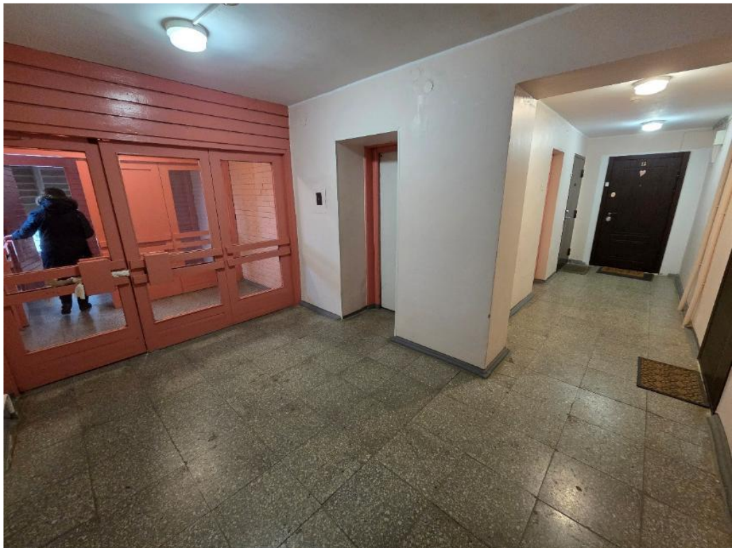
Foto 41. Sissepääs hoonesse on heas seisukorras, siseviimistlus on vananenud.
