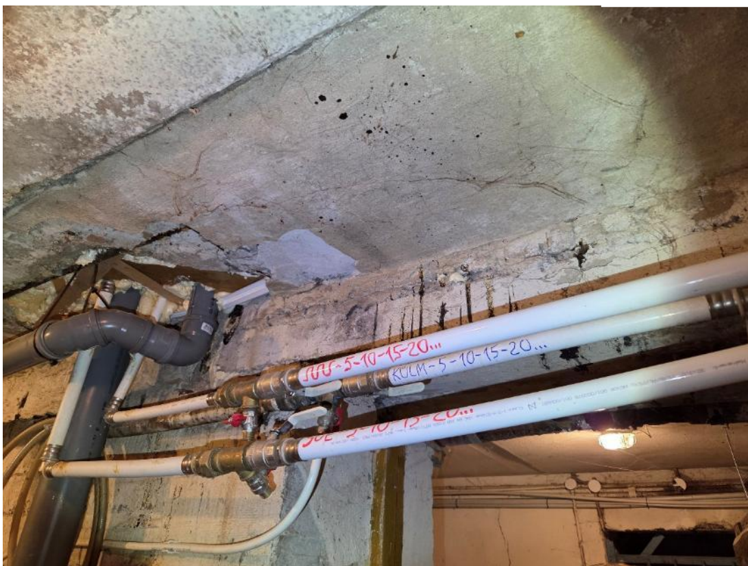
Foto 27. Torustikul napib kinnitusi, vaheviigul puuduvad tuletõkkemansetid, läbiviigud ei ole tihendatud.
