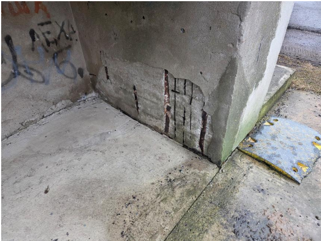
Foto 7. Paljanduv raud puhasada ja katta kaitsekihiga – soojustada ja lisada uus välisviimistlus.
