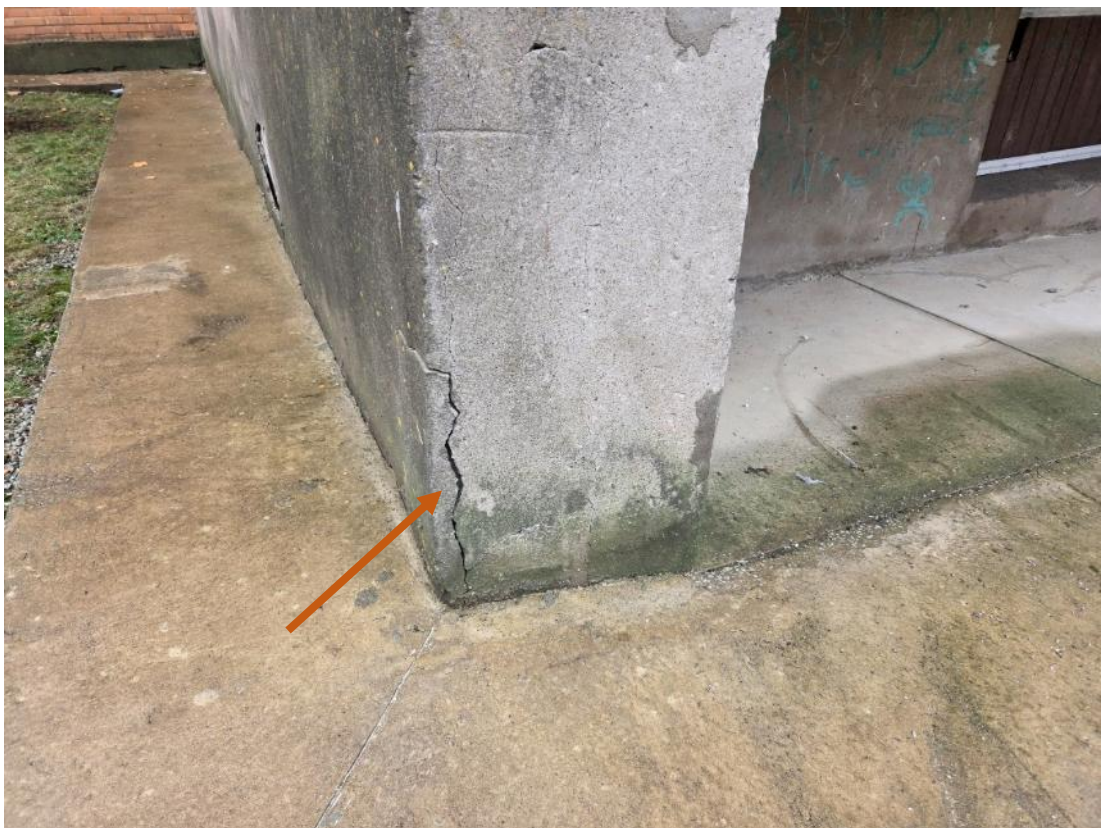
Foto 8. Sokli välisviimistlus on kahjustunud, esinevad praod – eemaldada lahtised osad, lisada soojustus, lisada uus välisviimistlus.
