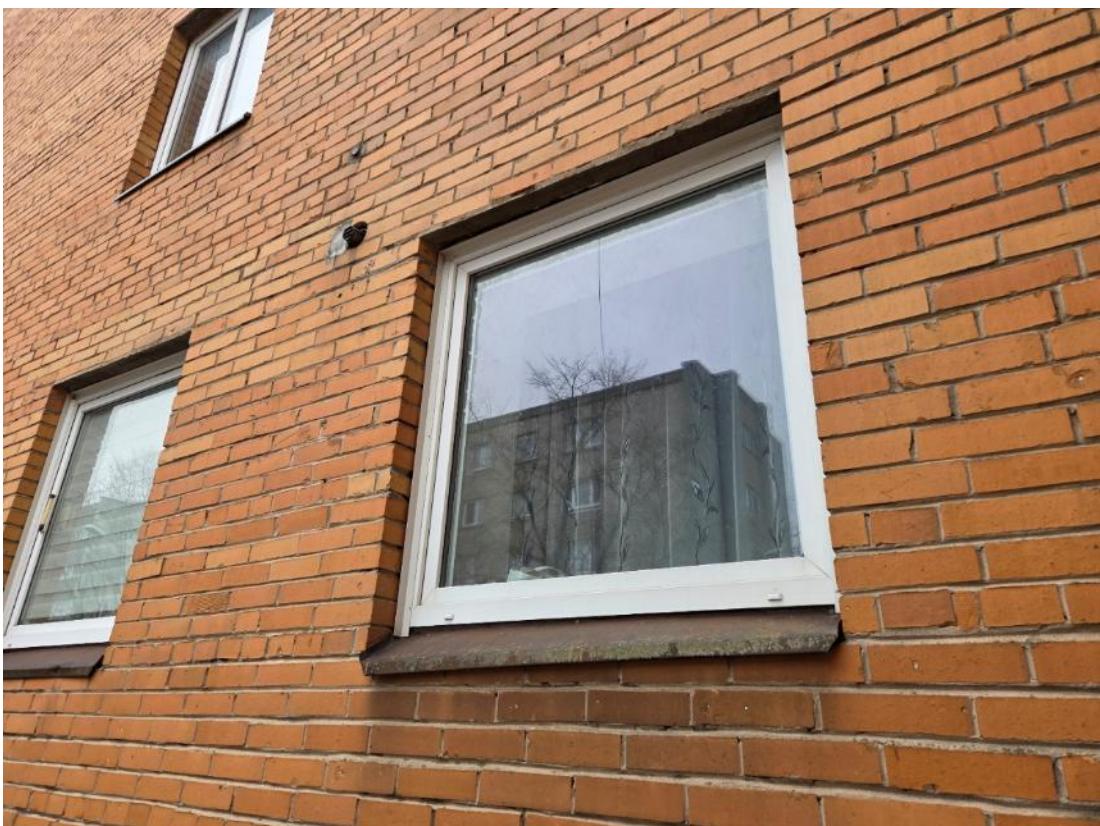
Foto 10. Akende ees on vanad aknaplekid, mis on täielikult amortiseerunud .
