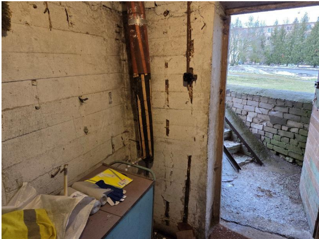
Foto 15. Sissepääs keldrikorrusele põhjaküljelt, vundamendis paljandunud terasest korrodeerunud osad.
