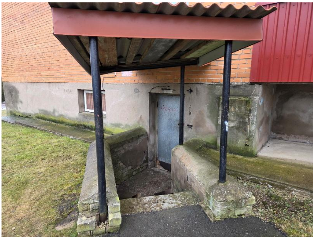
Foto 5. Lisasissepääsu ees keldrisse hoone põhjaküljel on vandalismijälgedega metalluks, trepipiirded amortiseerunud.
