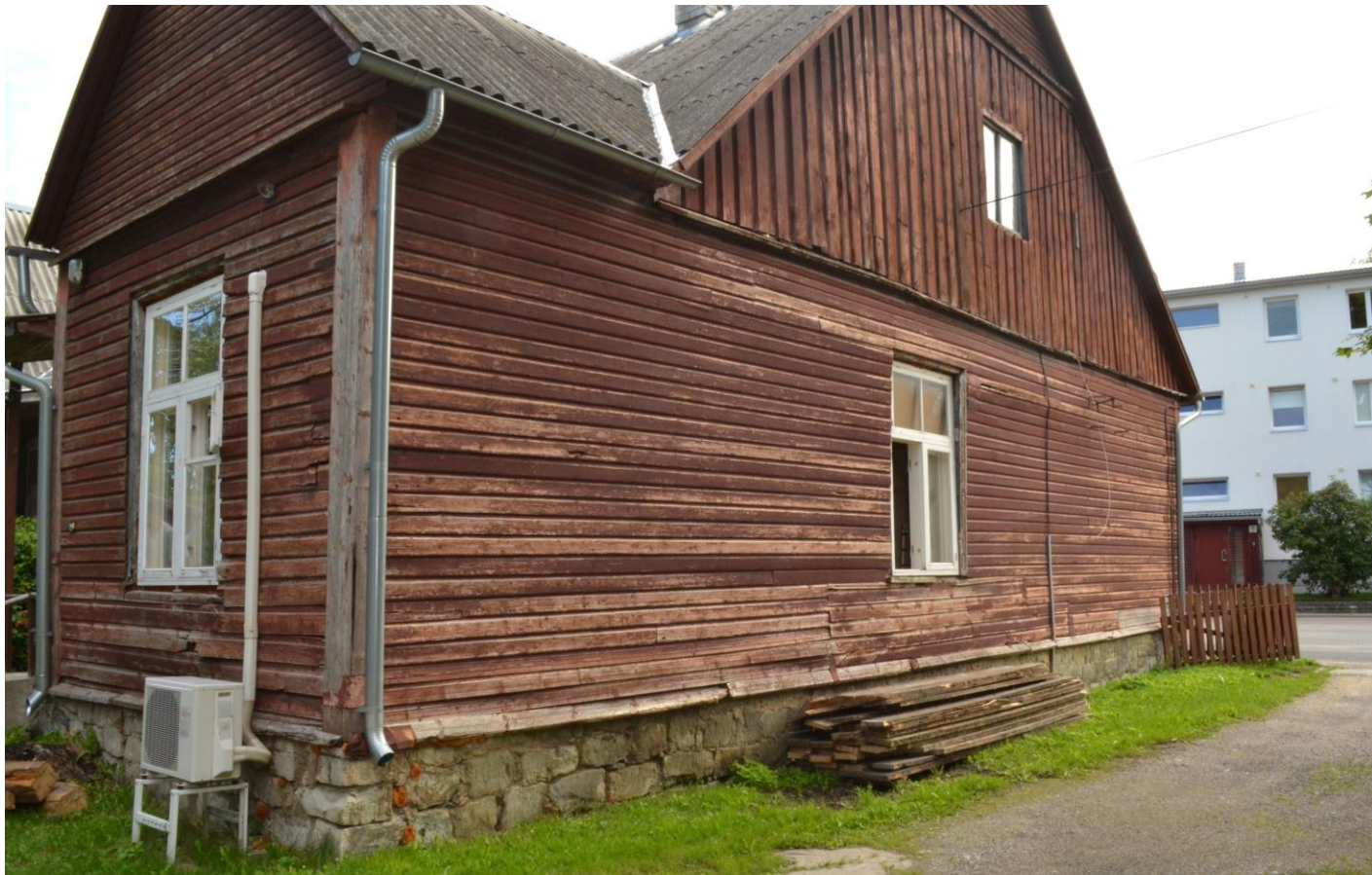
5. Lõunapoolne otsafassaad, kus sein on osaliselt välja vajunud. Vaade edelast.
