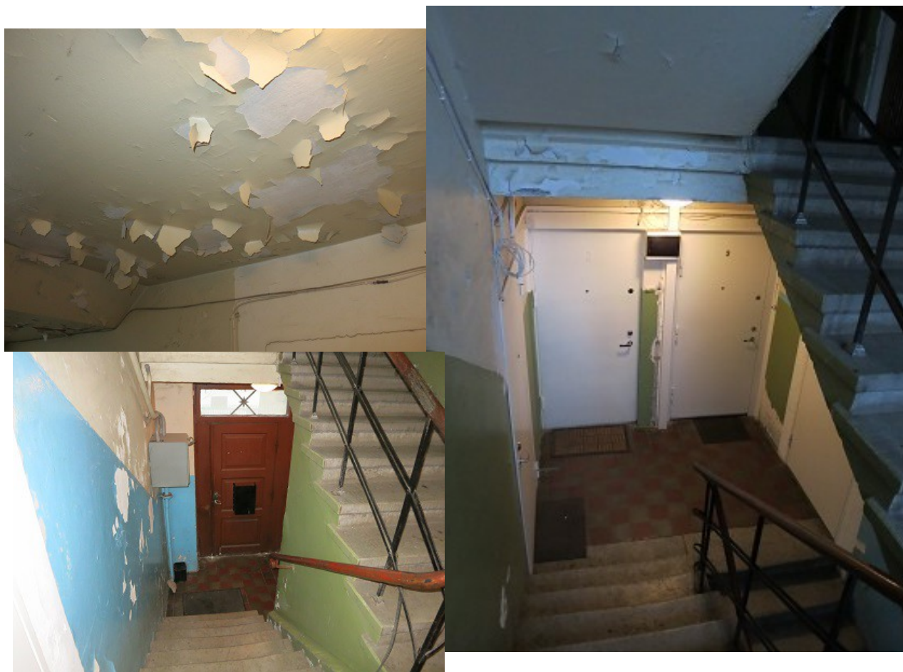
FOTOD 09, 10, 11. Hoone trepikoda. Lubikrohvi kantud õlivärv on kohati lahti koorunud. I korrusel trepikoja sein helesinise tooniga üle värvitud.
