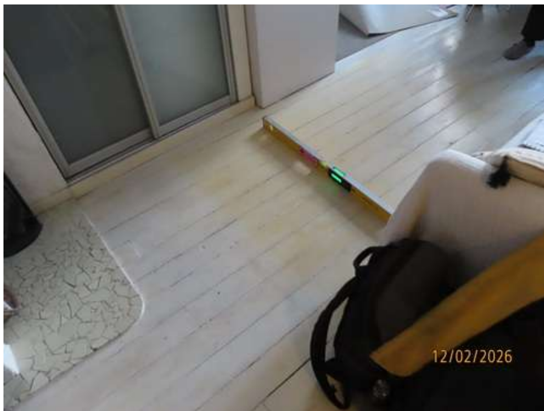
Foto 12. Risti taladega oli põranda kalle 0...1 mm/m.
