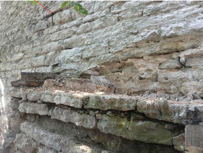
Lõhkumise tulemusena on tekkinud teise maja fassaadi mördi juurde augud
