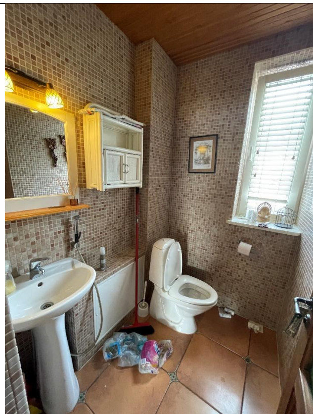
Foto 7. WC esimesel korrusel
