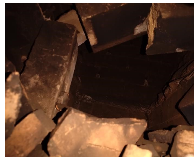
Foto 16: soojakapp varisenud kolde kohal
