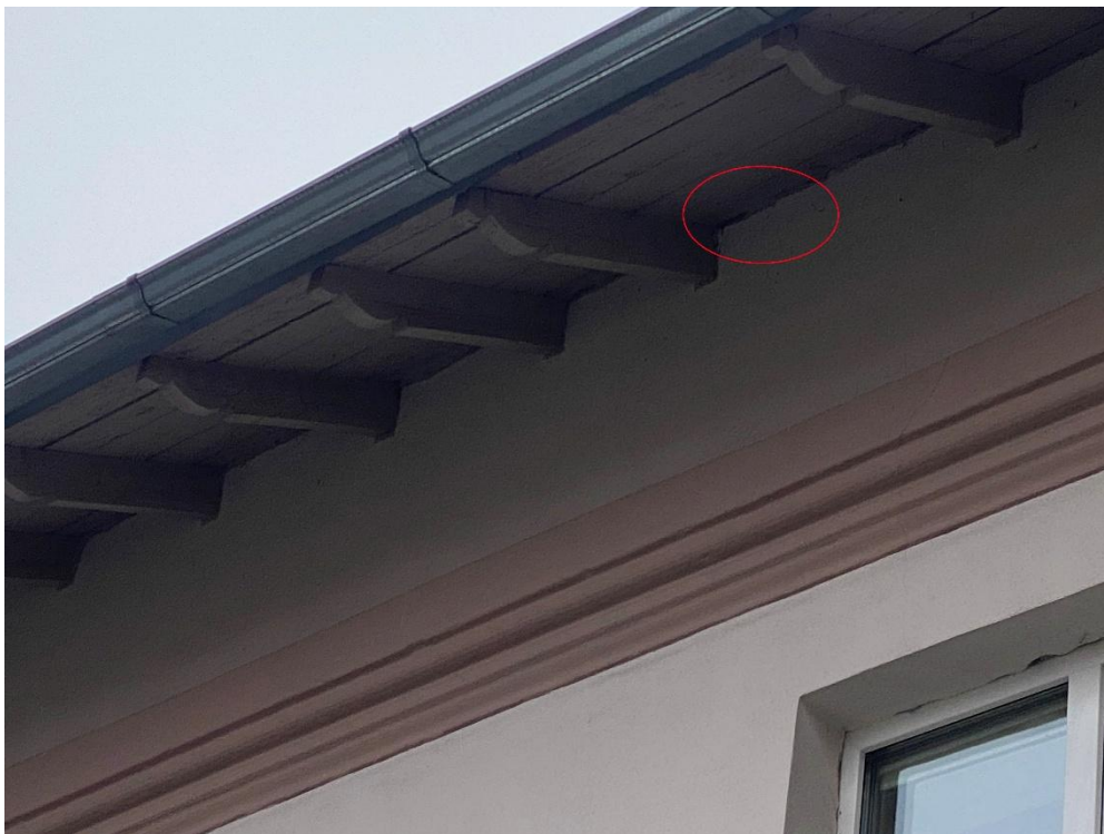
Foto nr 4 - Katuseräästas
