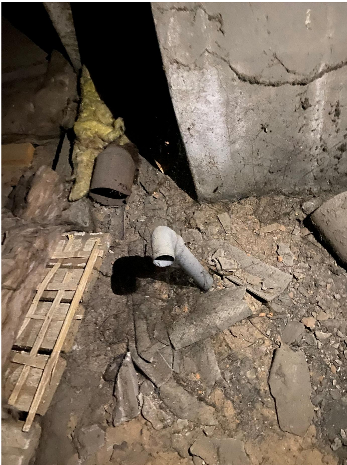
Foto nr 8 - Kanalisatsioonituulutus
