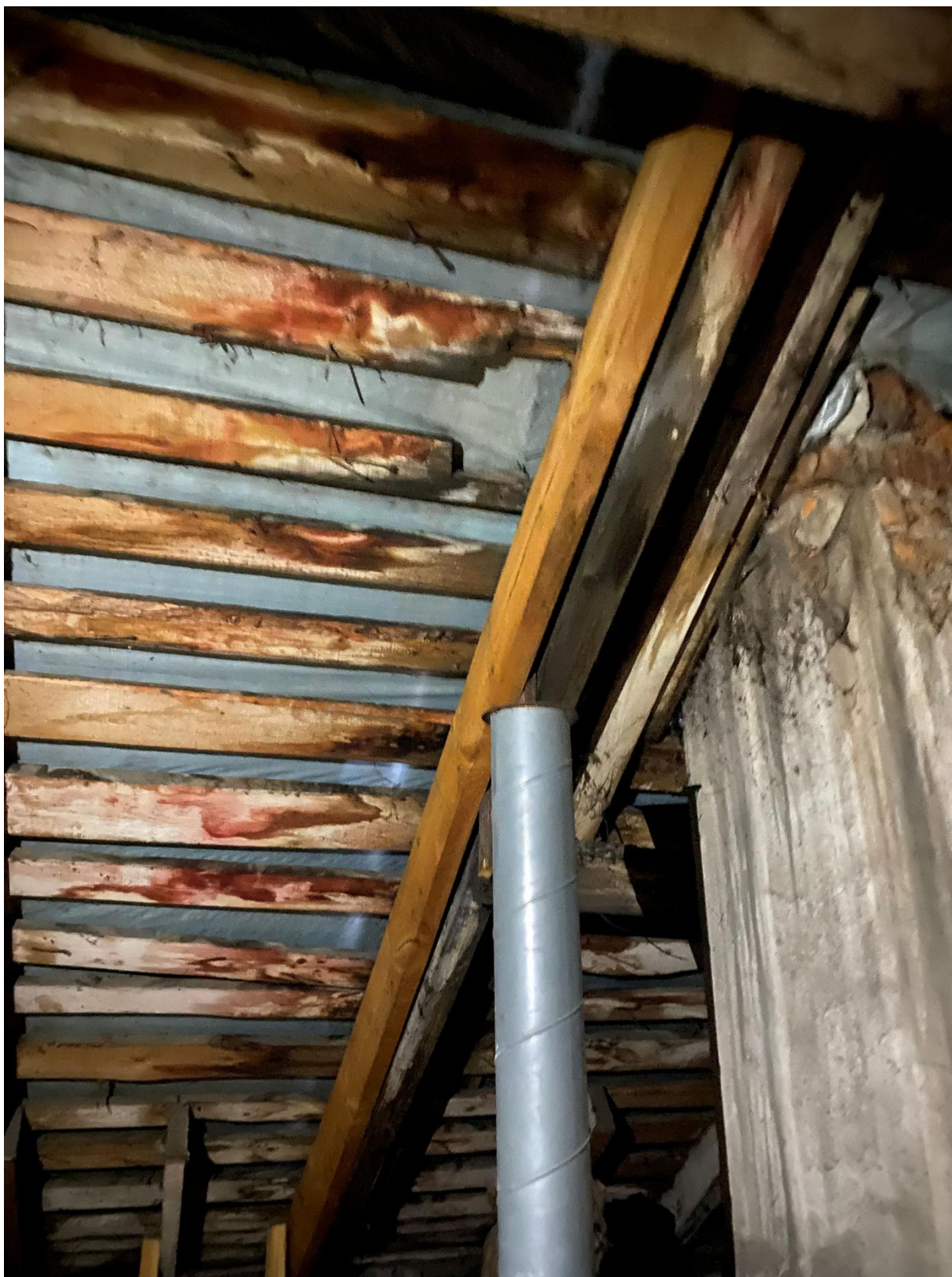
Foto nr 7 - Kanalisatsioonituulutus
