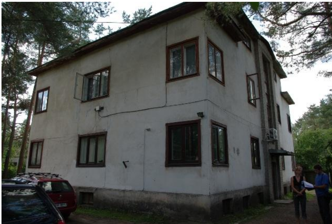
Fotol on näha õhuliini kinnitus räästa külge ning sidekaabel fassaadi välispinnal, mis
