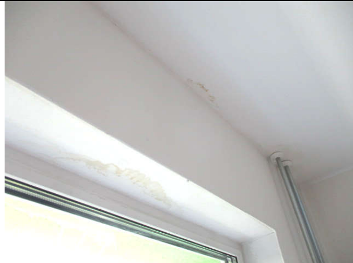
Foto nr. 13. Krt. 40 läbijooksud on tingitud lodža paneeli ja seina vahelise vuugi ebatihedusest.
