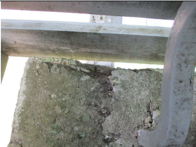
Fotod nr. 3-4. Põrandatel esineb betooni kahjustusi, avatud armatuuri.
