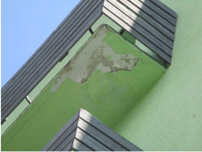
Fotod nr. 1-2. Vahelagede dekoratiivkrohv ja värvikiht lagunevad.
