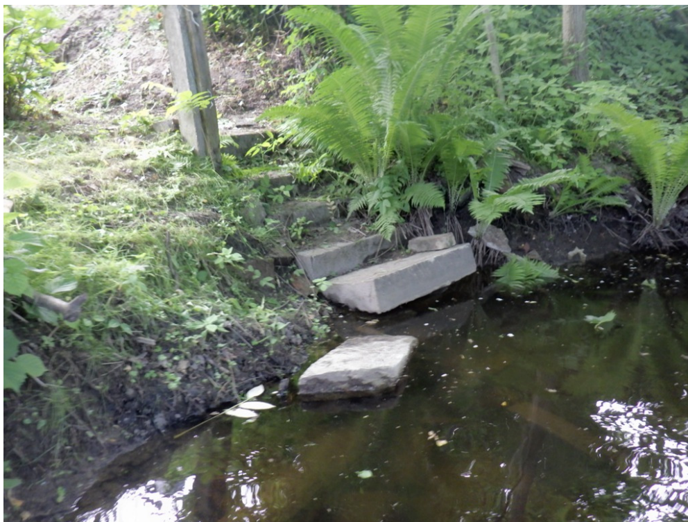
Foto 7. kinnistul olev trepp ja betoontala jõe põhjas
