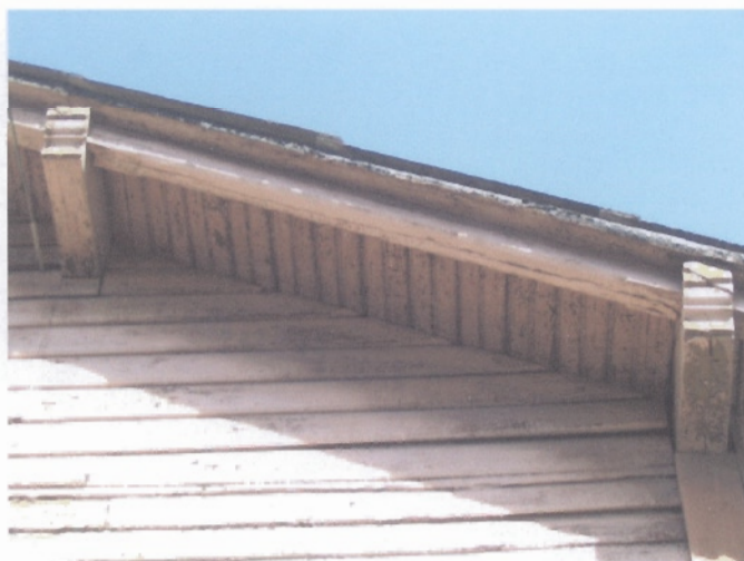
Foto 5 Elamu viiluseina räästa lähivaade. Müürlati ja vahepärlini otsad on profileeritud.
