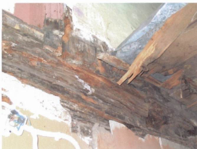
Foto 30 Tagumine trepikoda. Vaade trepi vahemademe seenkahjustustele ( Merylius Lacrymans ).
