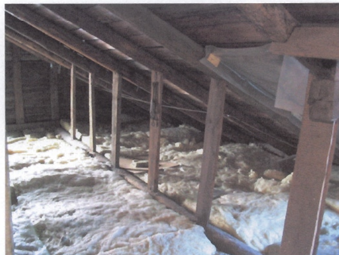
Foto 24 Sarikate tugipostid on hilisemad. Ehitusaegne katuse kandekonstruktsioon on hävinenud.
