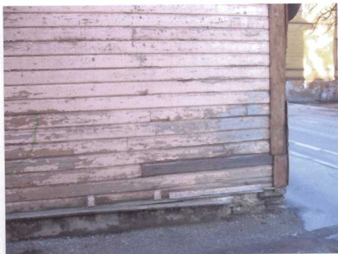
Foto 15 Otsaseina sokli vaade Kristiine poolt. Sokli krohviparandused on tehtud tsementmördiga
