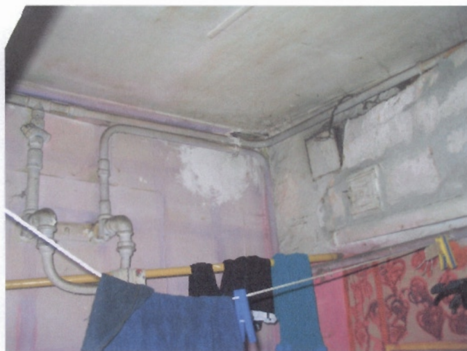
Foto 27 Algse vahelae vaade altpoolt. Vahelael on suured niiskuskahjustused.
