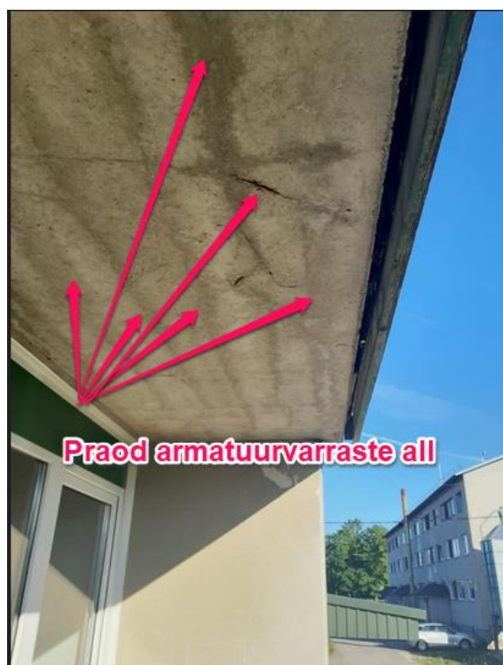
Foto „TÜÜPNE“. Fotol on näha hoone rõdupaneelidel esinev tüüpne olukord. Armatuuri roostetamise tõttu on tekkinud praod armatuurvarraste betoonist kaitsekihti, mis aja möödumisel eemaldub paneelist ning variseb.
