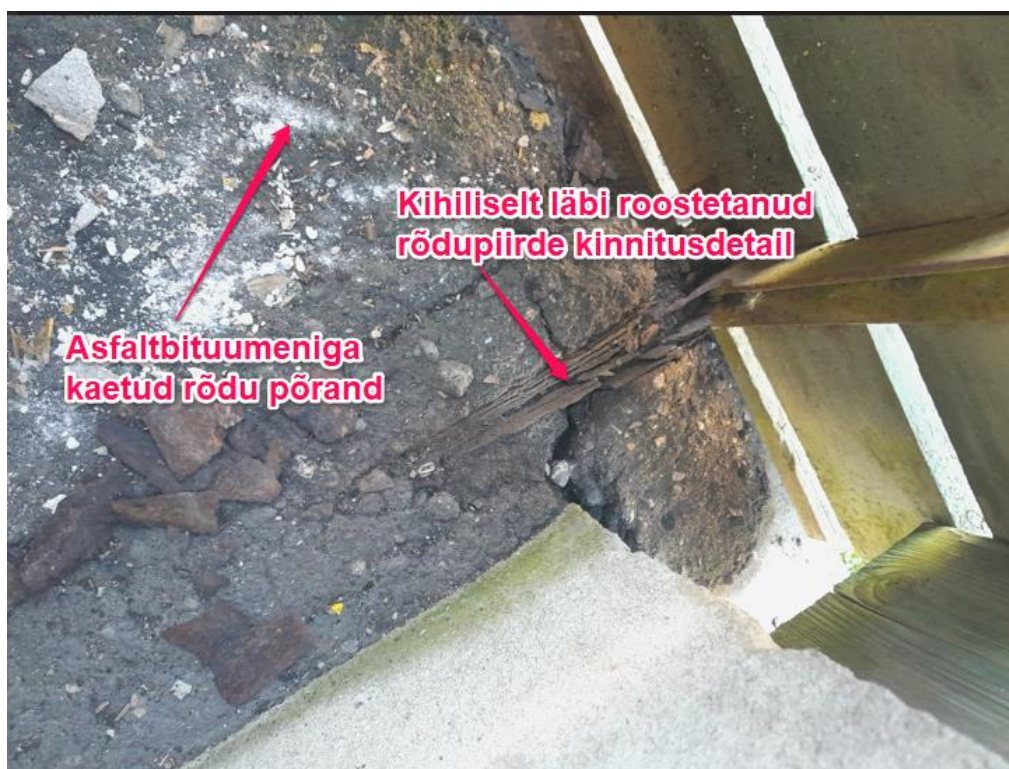
Foto F2. Korter 8 rõdu piirde kinnitus. Kõikide rõdude põrandad on kaetud asfaltbituumeniga, mis ei oma vajalikku korrosiooni kaitset rõdude piirete detailidele. Rõdu piirde kinnitusdetail on kihiliselt läbi roostetanud ja ei oma piisavat kandevõimet rõdu piirde fikseerimiseks ja koormuste vastu võtmiseks. Fotol kajastatud olukord on näha peaaegu kõikide korterite rõdude puhul.
