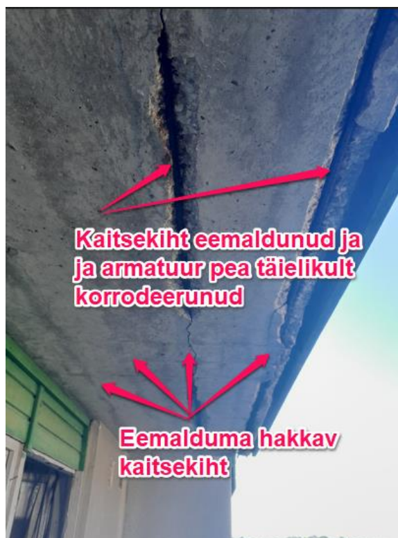
Foto F3. Korter 12 rõdu põranda paneel vaadelduna alt poolt. Armatuuri korrodeerumisest tingituna on betoonist kaitsekiht eemaldunud. Armatuur on tugevalt korrodeerunud. Sarnane olukord on ka korteri 11 rõdu põrandapaneelil.
