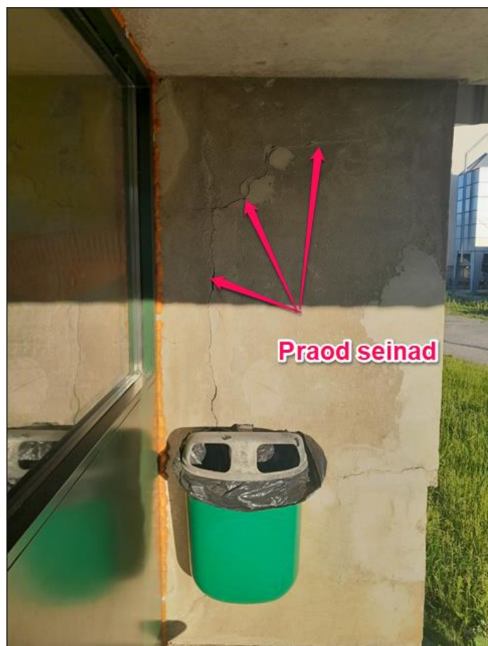
Foto F6. Vaade varikatust toetavale seinale. Varikatust toetavas seinas on tekkinud läbivad praod, mis on tingitud konsoolsena töötava varikatuse tagumisele servale tekkivast liigsest tõmbepingest ja vajaliku vastukaalu puudumisest. Varikatuse esiserv tuleb ajutiselt toetada.
