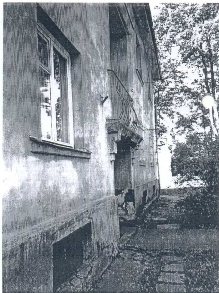
6 Niiskuskahjustused on kõige suuremad keldriosas. Puudub sokli plekk. Aknaplekk ja selle all olev karniis korrastada.
