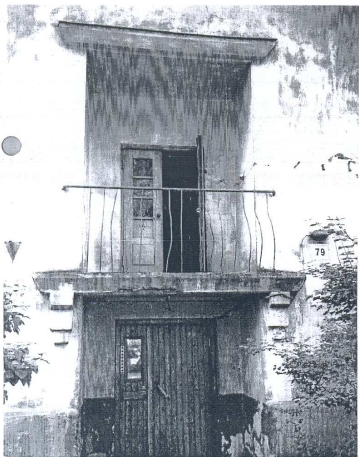
5 Vaade peauksele ja trepikoja rõdule. Rõdubarjäär on kõveraks painutatud. Rõdu uks on originaal. Uus uks teha puidust ja vana ukse eeskujul. Karniislile paigaldada plekk
