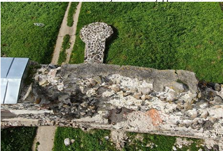
Foto 7. Konserveerimist ja katustamist vajavad müürid, fotod suunaga lõunast põhja, 1/3. Valatud betoonkiht.
