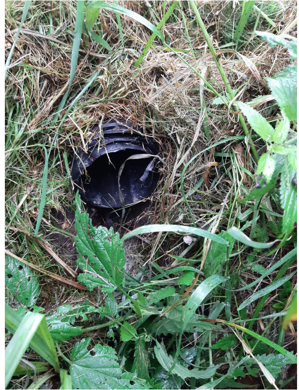
Pilt 6. Drenaazitoru väljavool mahasõdukoha juures (16.09.25)
