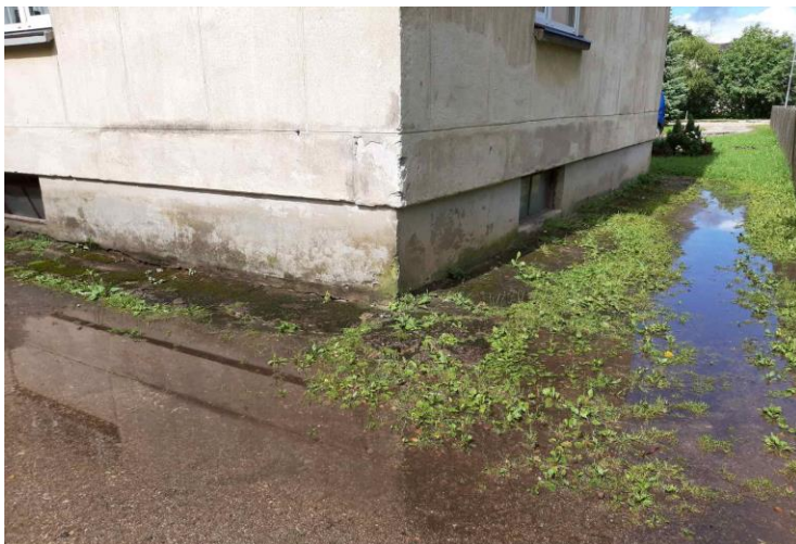
Foto 1 Pääsenud vesi keldrisse
