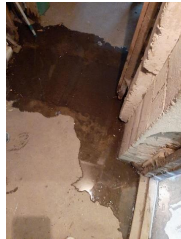
Foto 2 Pääsenud vesi keldrisse
