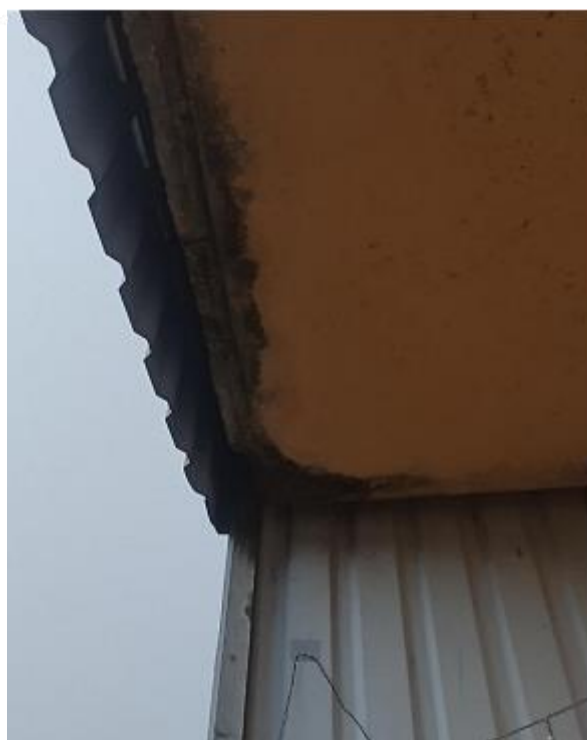
Foto 25. krt 52 Lae välisserv lagunenud, betooni on pudenenud ja armatuur on nähtaval.
