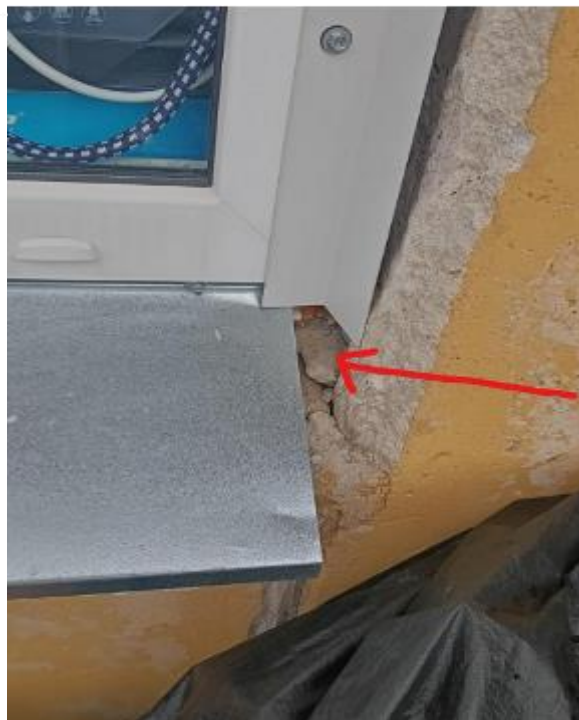
Foto 13. krt 28 Aknapleki ja akna ümbrus tihendamata, vesi/niiskus võib pääseda konstruktsioonidesse.
