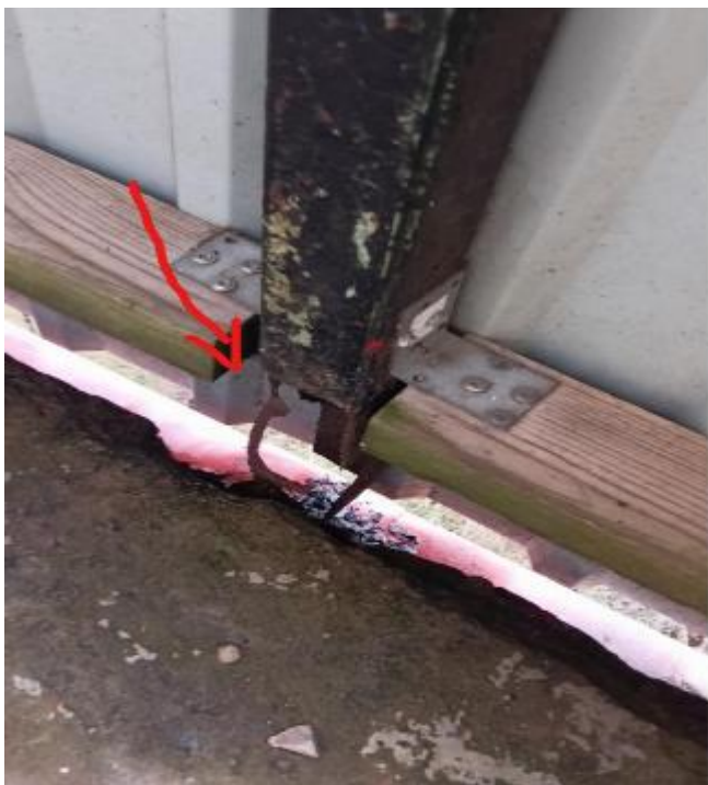
Foto 12. krt 28 Päärde post on läbi roostetanud. Kinnituskoht põrandaga puudub.
