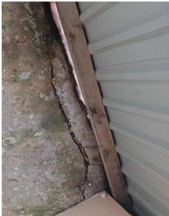
Foto 15. krt 28 Põranda välisservas kukkumisohtlikud betoonitükid.
