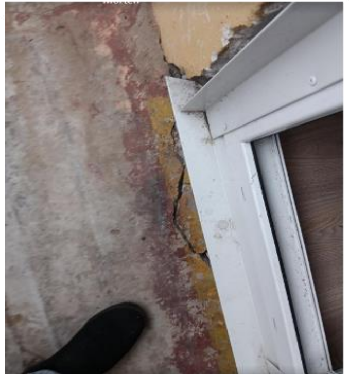
Foto 6. krt 7 Põranda kaldekihis pragu, põranda ja seina liitekoht pole veekindel, vesi võib pääseda konstruktsioonidesse ja tekitada alumise korruse korteris vee ja niiskuse kahjustusi.
