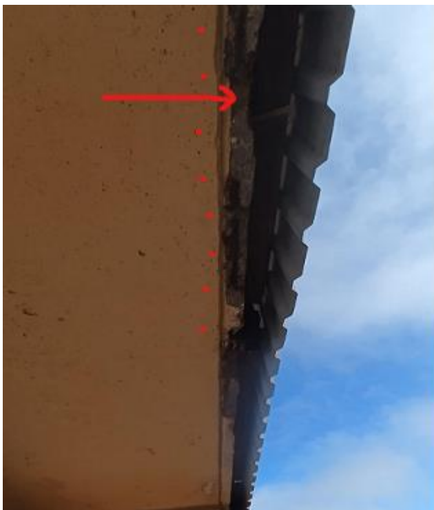
Foto 24. krt 44 Lae välisserv lagunenud, betooni on pudenenud ja armatuur on nähtaval.
