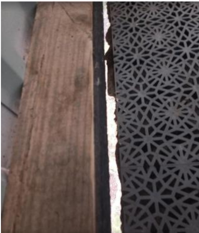
Foto 2. krt 4. Rõdupõranda välisserv lagunenu
