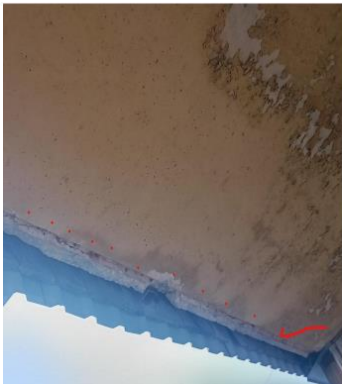
Foto 9. krt 21 lagi avariiline, lae välisservast on kukkunud betooni ja armatuur on nähtaval.
