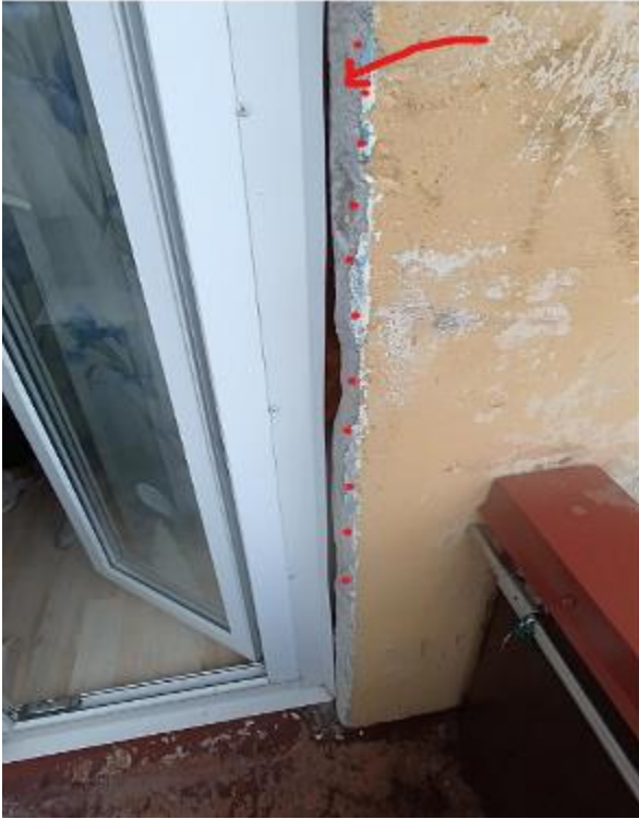
Foto 20. krt. 37 Rõdu ukseümbrus pole tihendatud, niiskus ja vesi võib pääseda konstruktsioonidesse.
