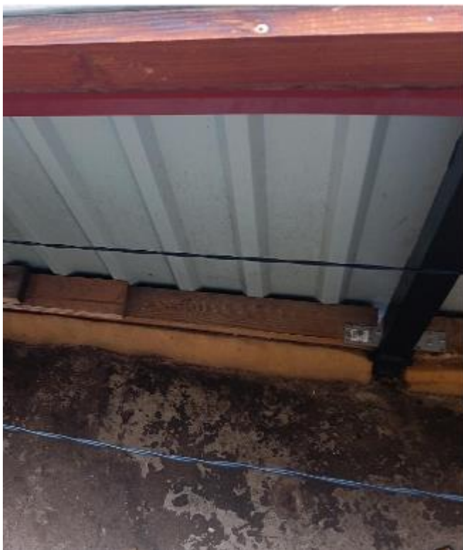
Foto 8. krt 12 Välispiirdel puuduvad alumised metallist L nurgad mille külge peaks pruss kinnituma, pruss on paigaldatud nurgikutega metallpostide külge.
