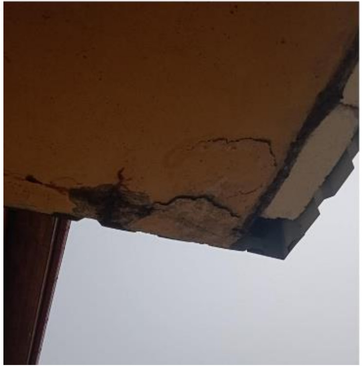
Foto 21 krt 38 Laest betooni pudenenud, armatuur nähtaval.
