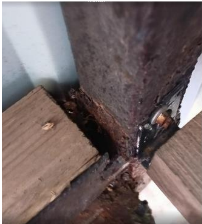
Foto 17 krt 36 Välispiirde alumine L raud läbi roostetanud.
