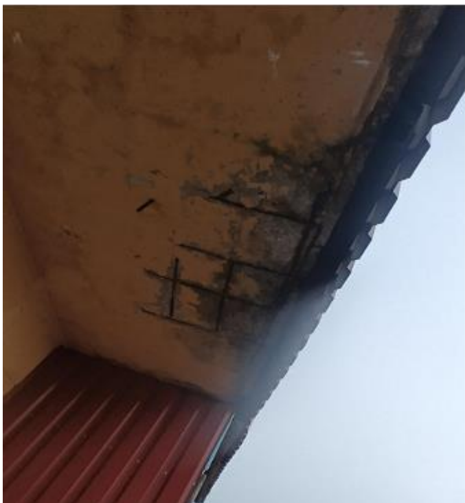
Foto 18. krt 37 Avariilises korras lagi, rõdu tuleks ajutiselt toetada ja hiljem täielikult uus rõdu teha.
