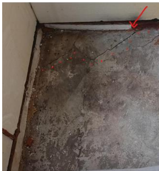
Foto 11. krt 25 Põranda kaldekihis praod. Põrand on ehitatud umbseks.
