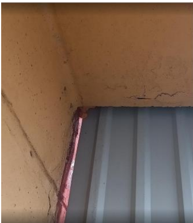
Foto 3. krt 4 Laes pudenemisohtlikud betooni tükid.
