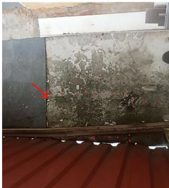
Foto 19. krt 37 Põranda kaldekihis praod.
