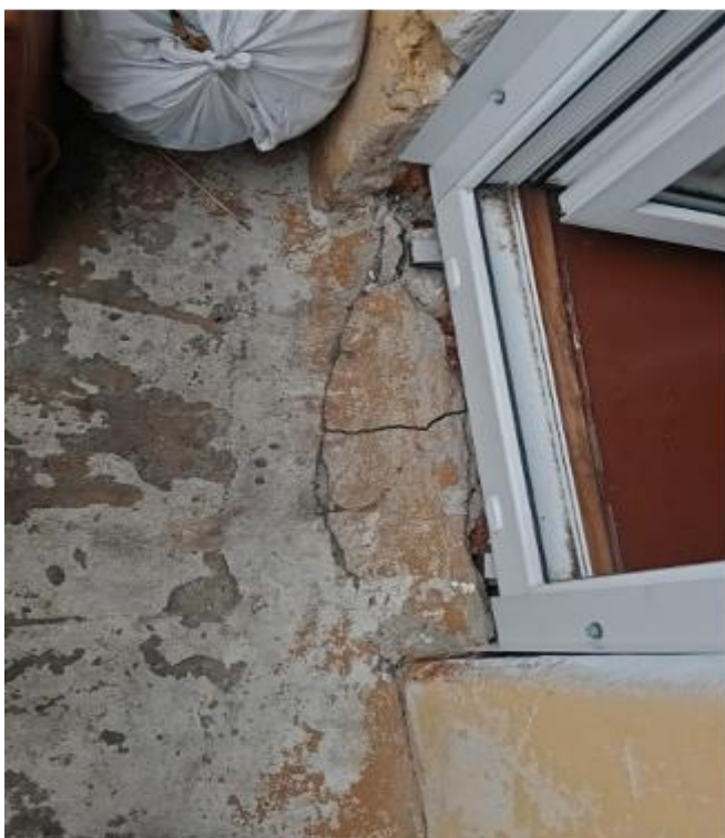
Foto 14. Krt 28 Puudub rõduukse plekk, kaldekihis on praod ja ukseümbrus ei ole vee- ega niiskusekindel.
