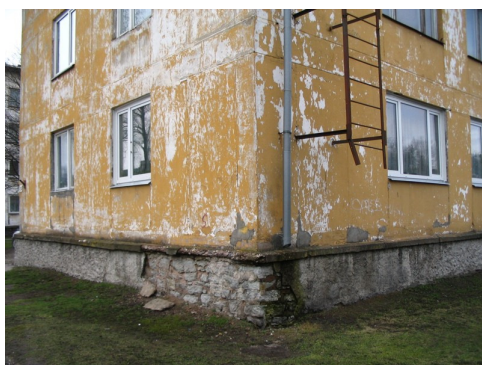
Vihmaveest tingitud vundamendikahjustused
