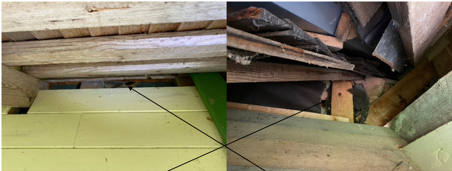
Fotod 32 ja 33. Fotod 32 on vaade vanema hoone osa räästas näha olevatele aukudele tuuletökkis. Fotod 33 on vaade juurdeehituse osas tuuletökkepaberi rebenemisele.
