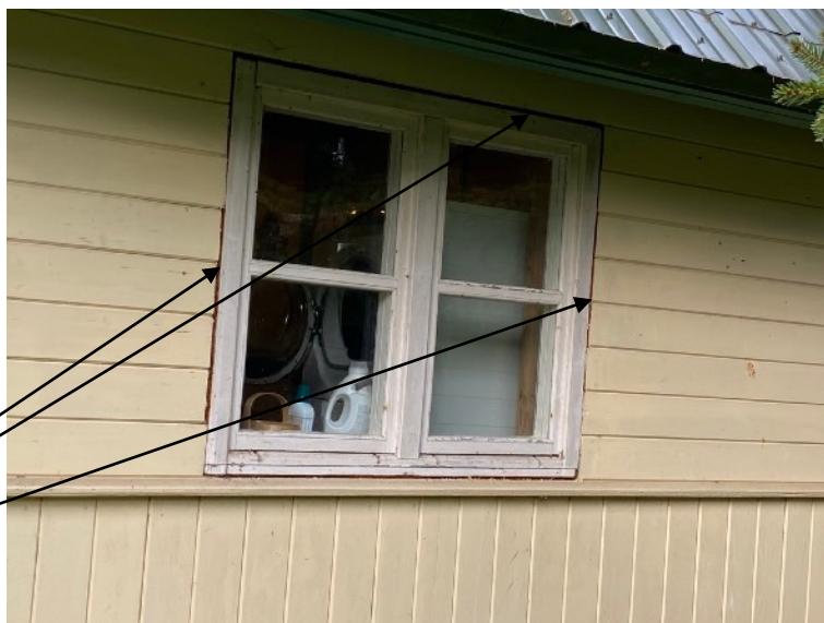
Foto 24. Juurdeehituse tänavapoolse fassaadi aknal puuduvad piirdeliistud.
