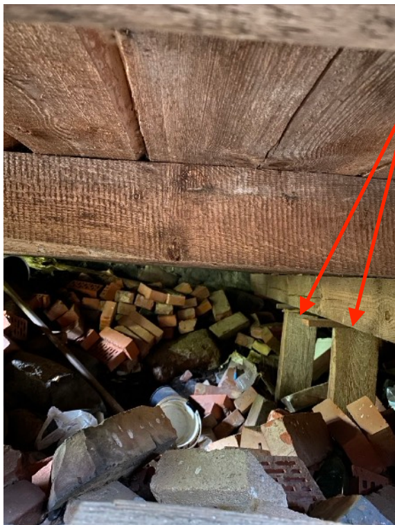
Foto 44. Puudub nähtav kinnitus veranda põrandatalade ja tugipostide vahel.
