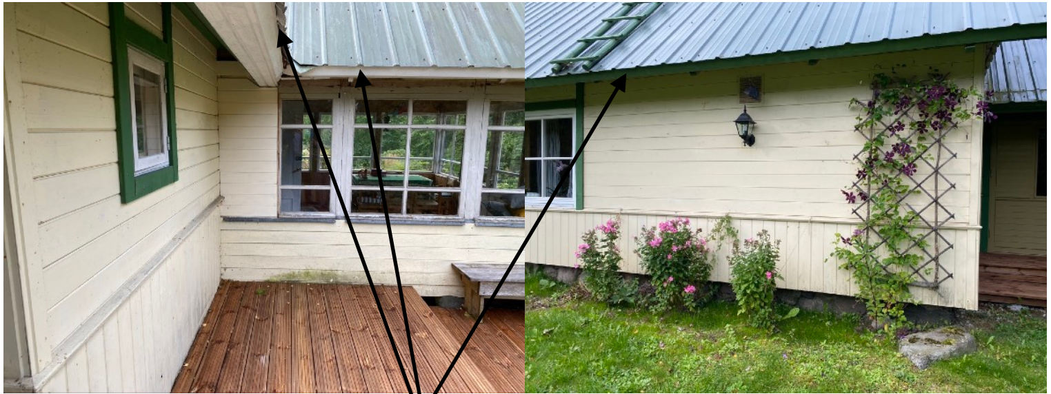
Fotod 3 ja 4. Puuduvad alumised räästa kaitseplekid kõikidel katuse külgedel.
