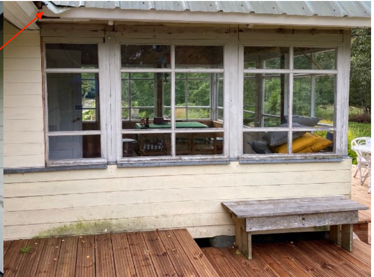
Fotod 25 ja 26 üleval. Puuduvad piirdeliistud veranda osas.
