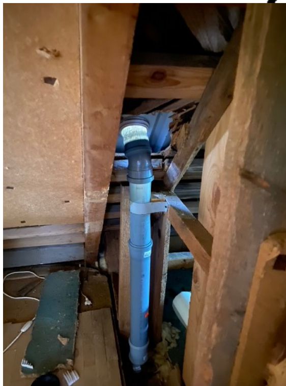
Foto 23. Vaade kanalisatsiooni tuulutustoru läbiviigule katusest. Puuduva aluskatte tõttu ei ole takistatud plekk-katte all tekkiva kondensaadi valgumine pööningule.
