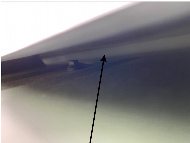
Foto 5. Vaade katuse harjapleki alla. Puudub profiilikujuline tihend!
