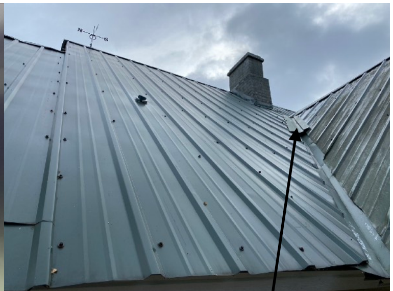
Foto 6. Vaade katuse neelule. Ebaõigesti paigaldatud neelu kaitseplekk, arusaamatu täiendav üksik plekk, tihendamata läbiviik.
