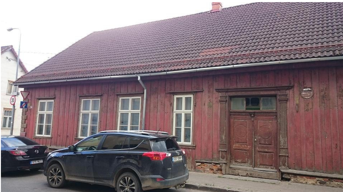
Foto nr 9. Lagunenud sokkel, pool.. Vihmaveetoru alumine osa on vandaalide poolt kahjustatud.
