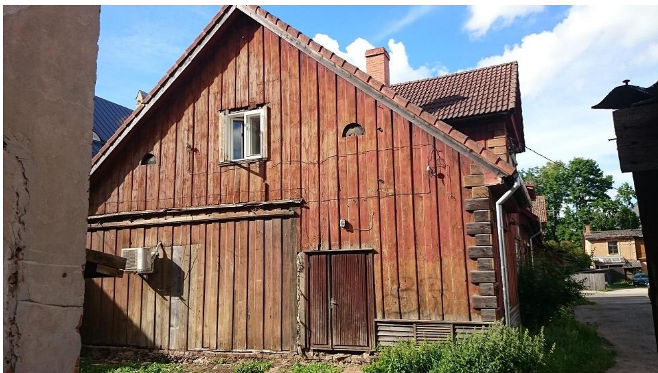
Foto nr 28 Vaade lõunast. Seinal on nähtav kunagine juurdeehitus. Otsaviilu all olevatele „silmakujuliste“ aknaavadele paigaldada aknaraamid ja piirdelauad või ainult klaasida. Seinal hulgaliselt mittevajalikke kaableid
