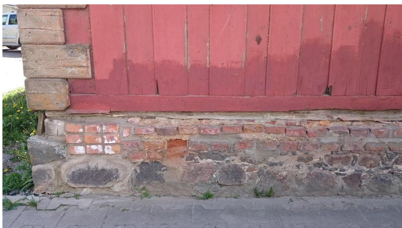
Foto nr 13 Põhjapool soklilaud puudu, nurgakivid puuduvad
