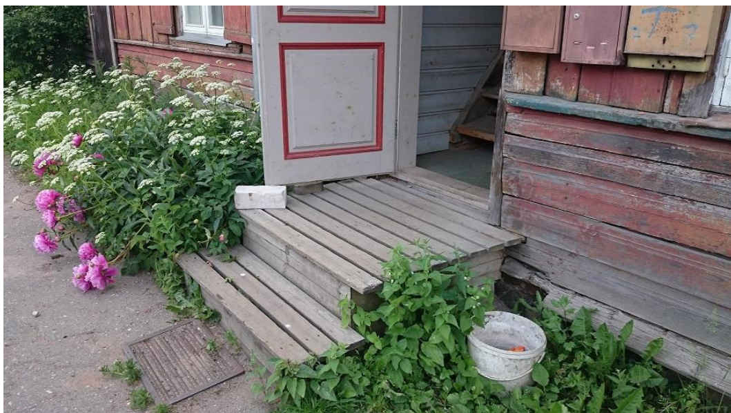
Foto nr 26 Idapool olev puidust välistrepp ja horisontaalne sobimatu laudis. Vanad postkastid vahetada välja ja leida sobivam koht.
