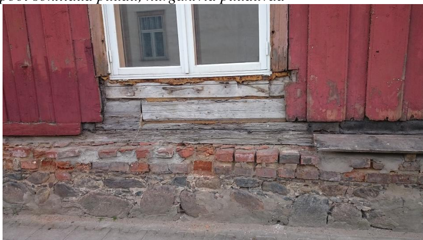
Foto nr 14. Aknaalused laudad puuduvad, alumine palk kahjustustega.
