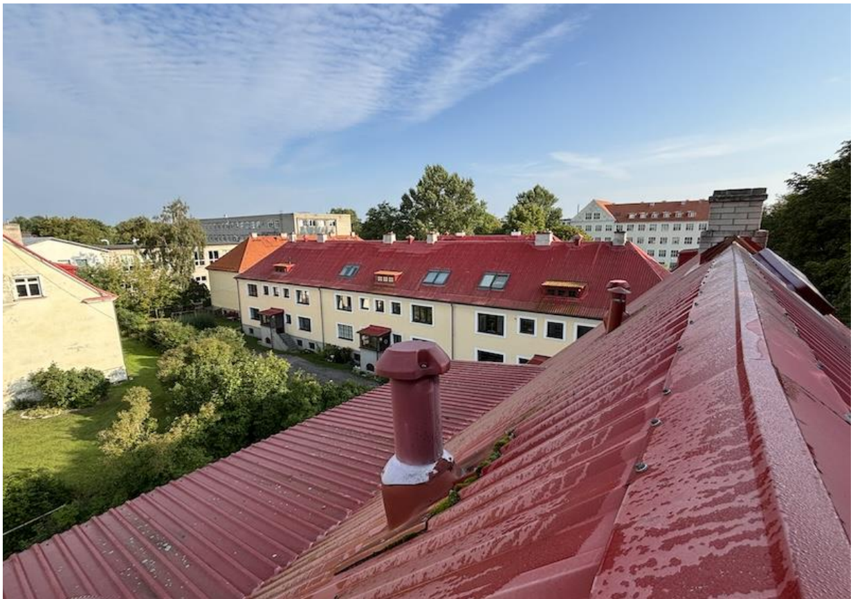
Fotod 9-10. Vaated katusele pealt küljest, puuduvad käiguteed, platvormid, lumetõkked.
