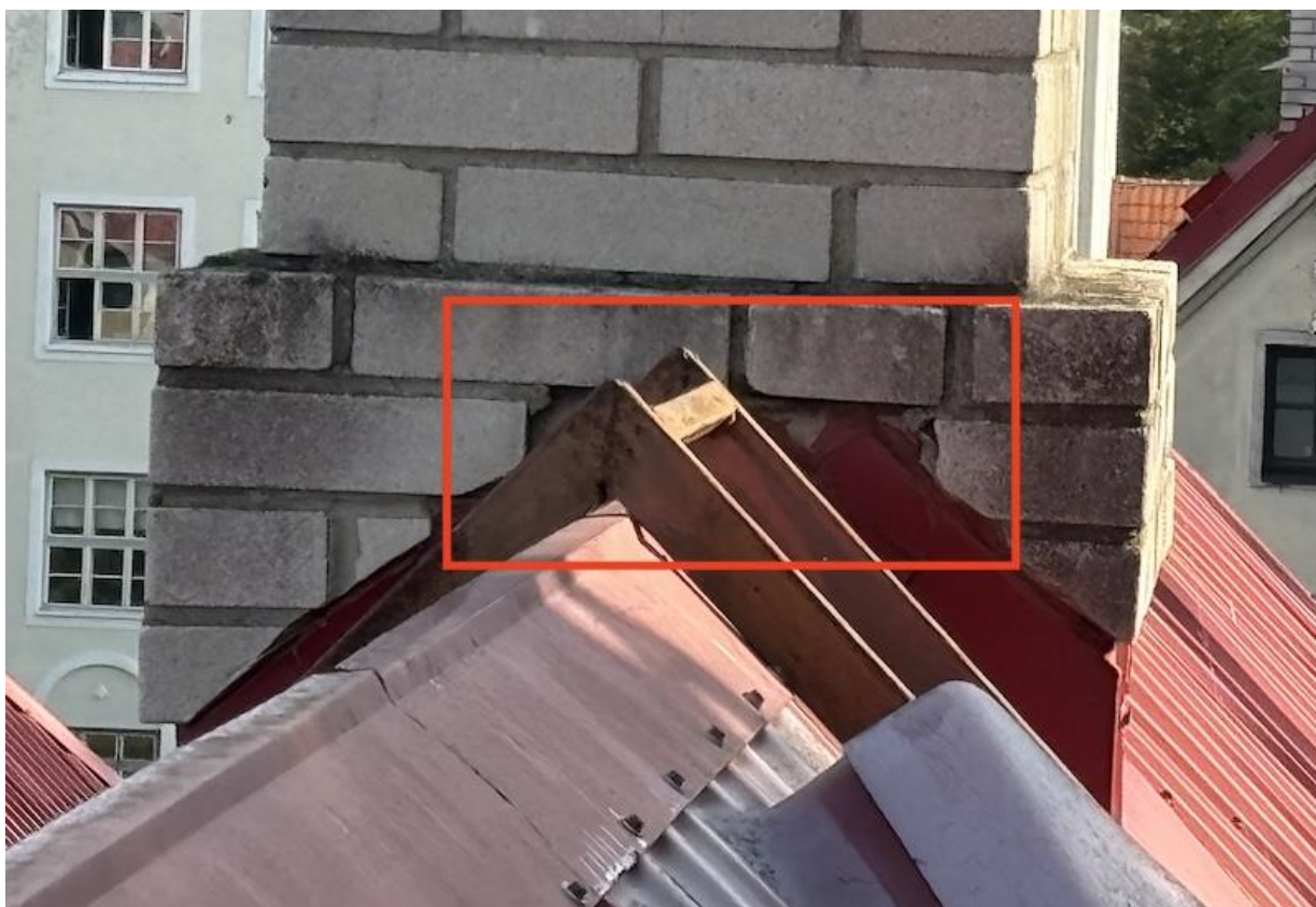
Fotod 13-14. Korstnate läbiviigud ei ole ilmastikukindlad.
