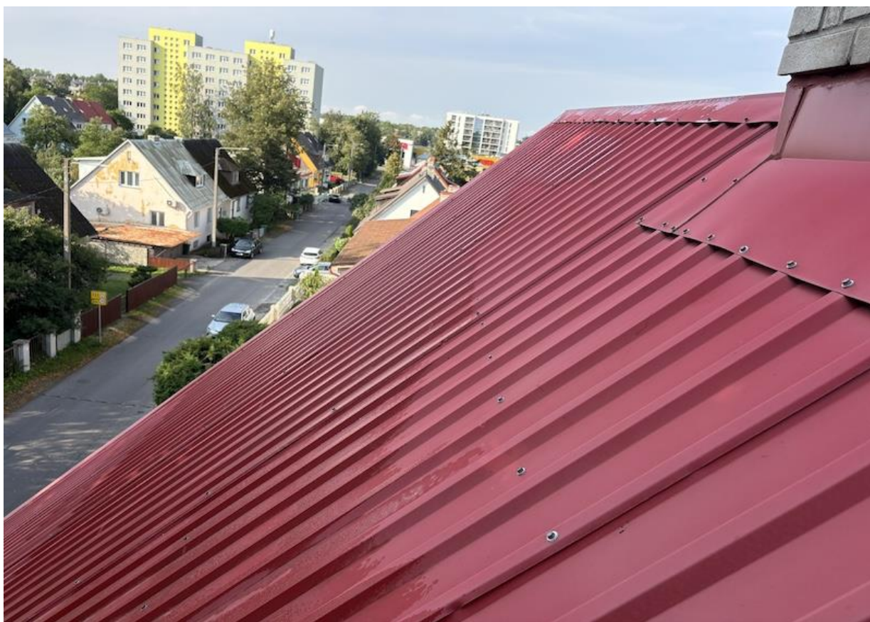
Foto 6. Vaated katusele pealt küljest, puuduvad käiguteed, platvormid, lumetõkked.
