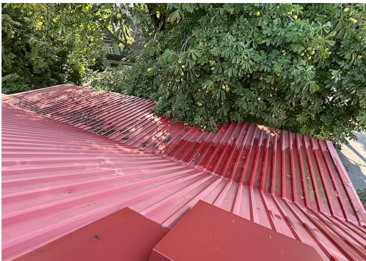
Fotod 7-8. Vaated katusele pealt küljest, puuduvad käiguteed, platvormid, lumetõkked.
