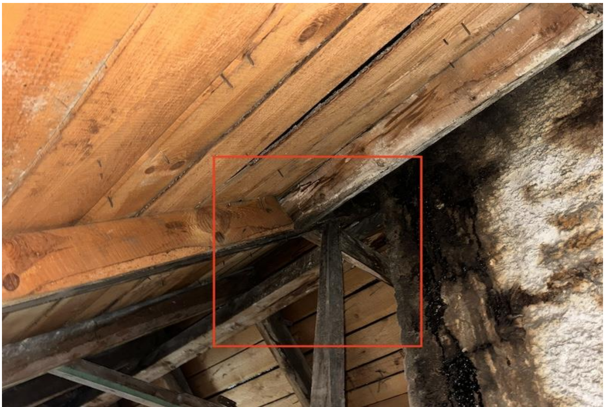
Foto 36. Katuse puitkonstruktsioonidel esineb pindmiseid niiskuse jälgi.
