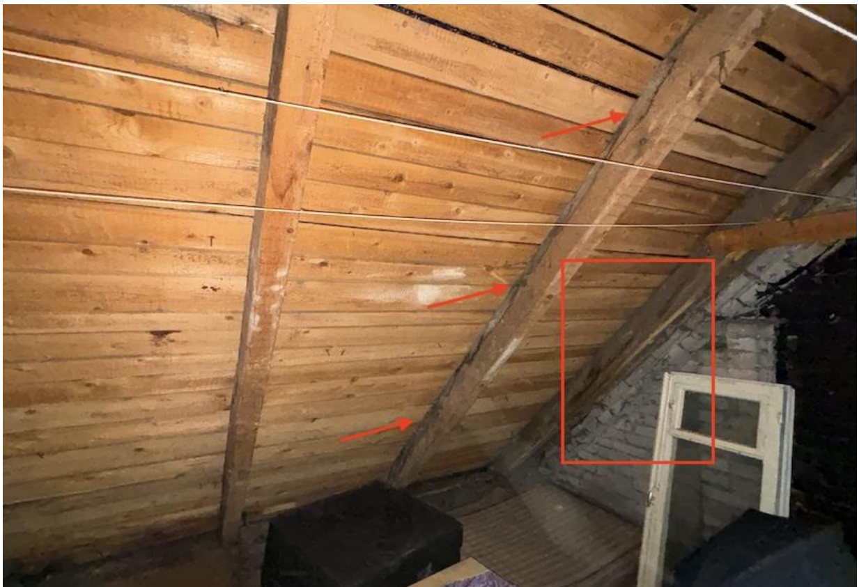
Foto 29. Katuse puitkonstruktsioonidel esineb peamiselt pindmiseid niiskuse jälgi.
