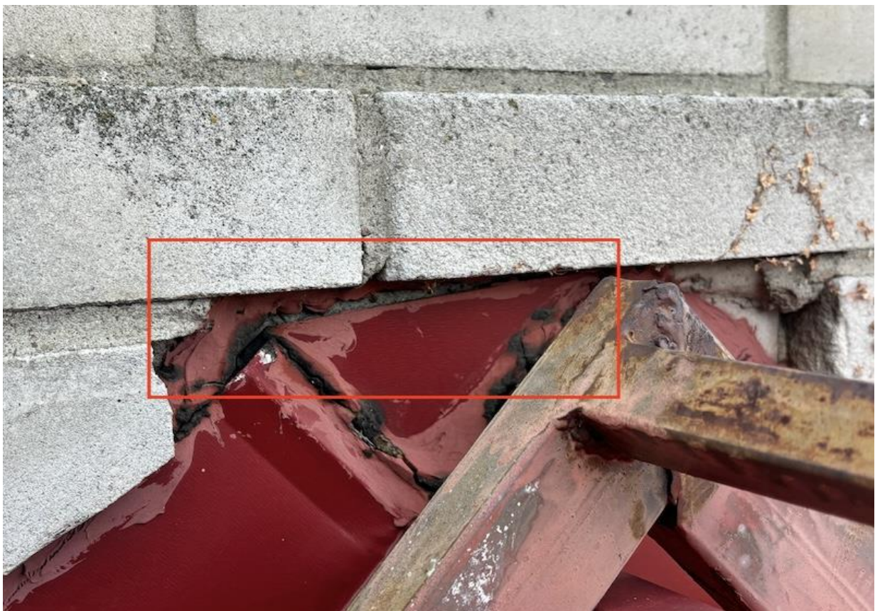
Foto 12. Korstnate läbiviigud ei ole ilmastikukindlad.
