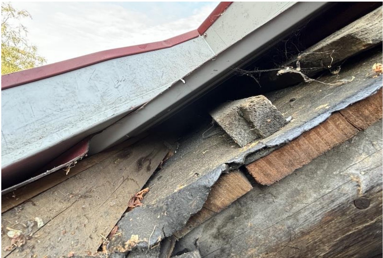
Foto 45. Olemasoleval katusel puudub katuse aluskate ja katusekatte alue tuulutus.
