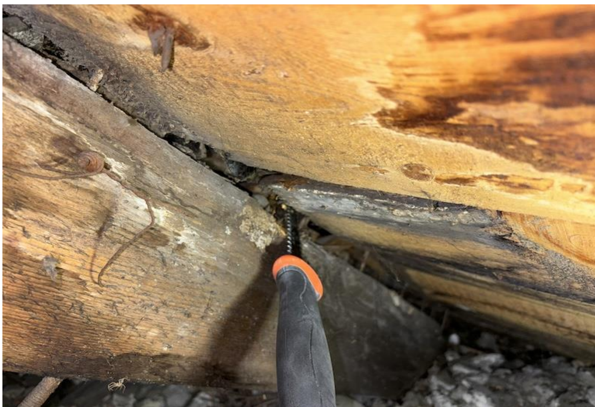
Fotod 38-39. Katuse tänava poolsel küljel on üks sarikas pehastunud ja murnunud pooleks, nuga siseneb puitu ilma vaevata.
