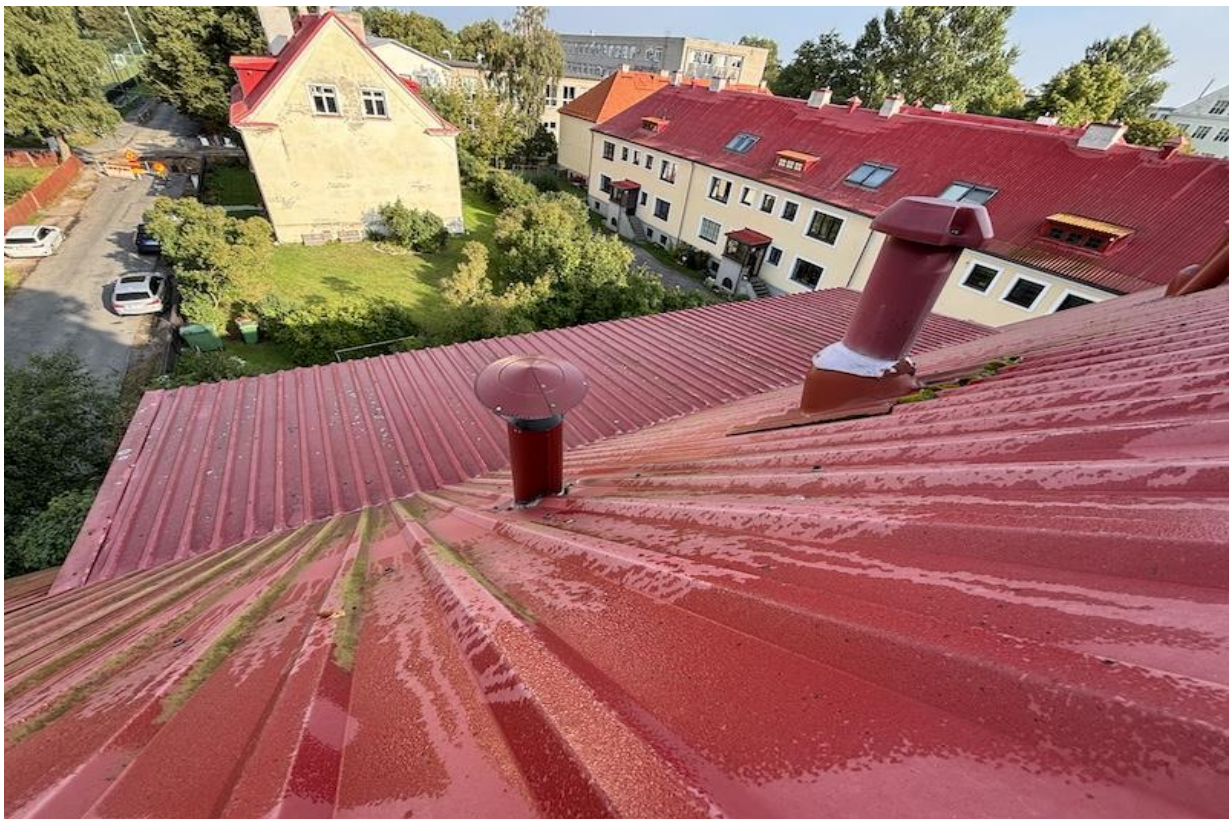
Foto 11. Vaated katusele pealt küljest, puuduvad käiguteed, platvormid, lumetõkked.
