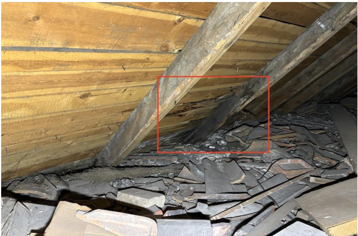
Foto 37. Katuse tänava poolsel küljel on üks sarikas pehastunud ja murnunud pooleks, nuga siseneb puitu ilma vaevata.
