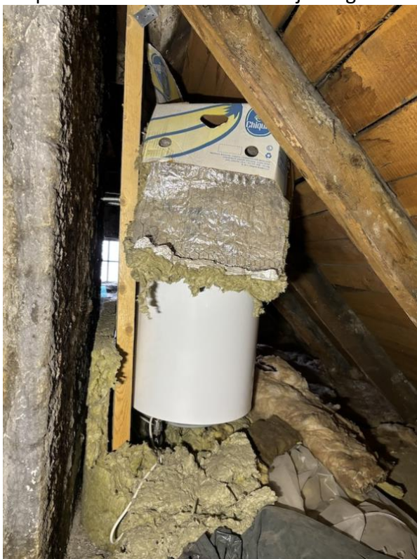
Foto 26. Pööningul paiknev ühe korteri soojaveeboiler.
