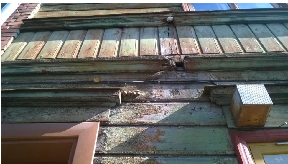
Foto 18 puitfassaadid renoveerida, fassaadidelt eemaldada ajaloolisse keskkonda mittesobivad seadmed
