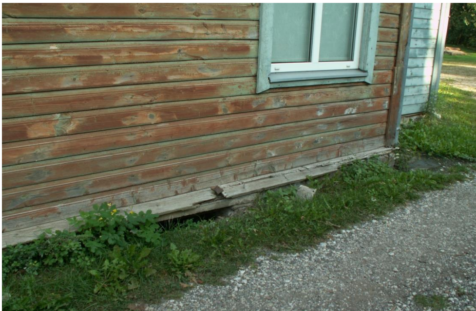
Foto 16 sokkel vajab remonti ja keldriaken taastamist
