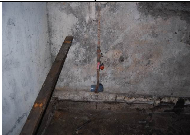
Foto nr. 15. Küte jaotustorud on vanad. Isolatsioon on amortiseerunud, osaliselt puudub.
