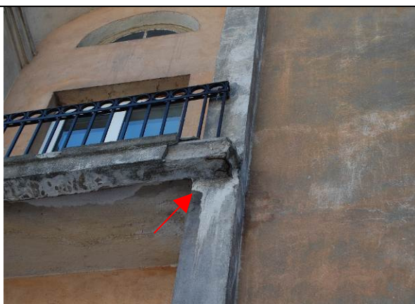
Foto nr. 5. Rõdud tuleb renoveerida.
