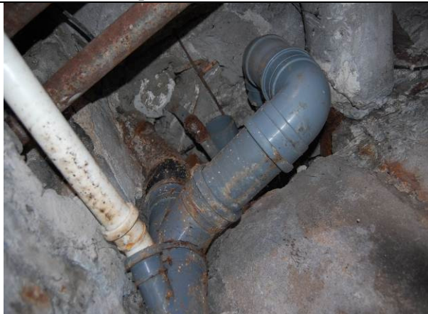
Foto nr. 14 Kanalisatsiooni püstikud on osaliselt vahetanud.
