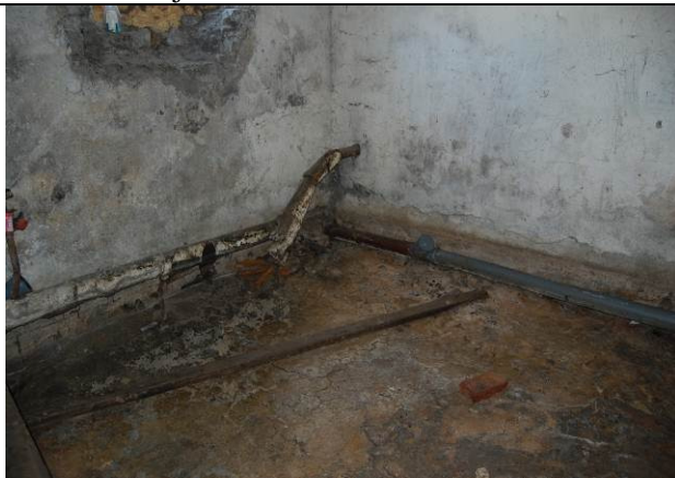
Foto nr. 17. Põrand on vaja betoneerida.
