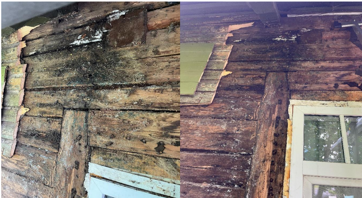
Foto 3 ja 4 – Seenkahjustused ja mädanik välisseinte kandekonstruktsioonides.
