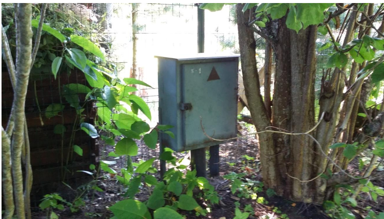
Foto 5: Elektrivõrgu liitumiskilp krundi piiril.
