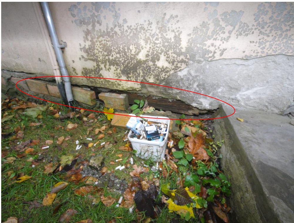
Foto 2. Alumine palk on kahjustunud, vajab Fibro plokkidega asendamist
