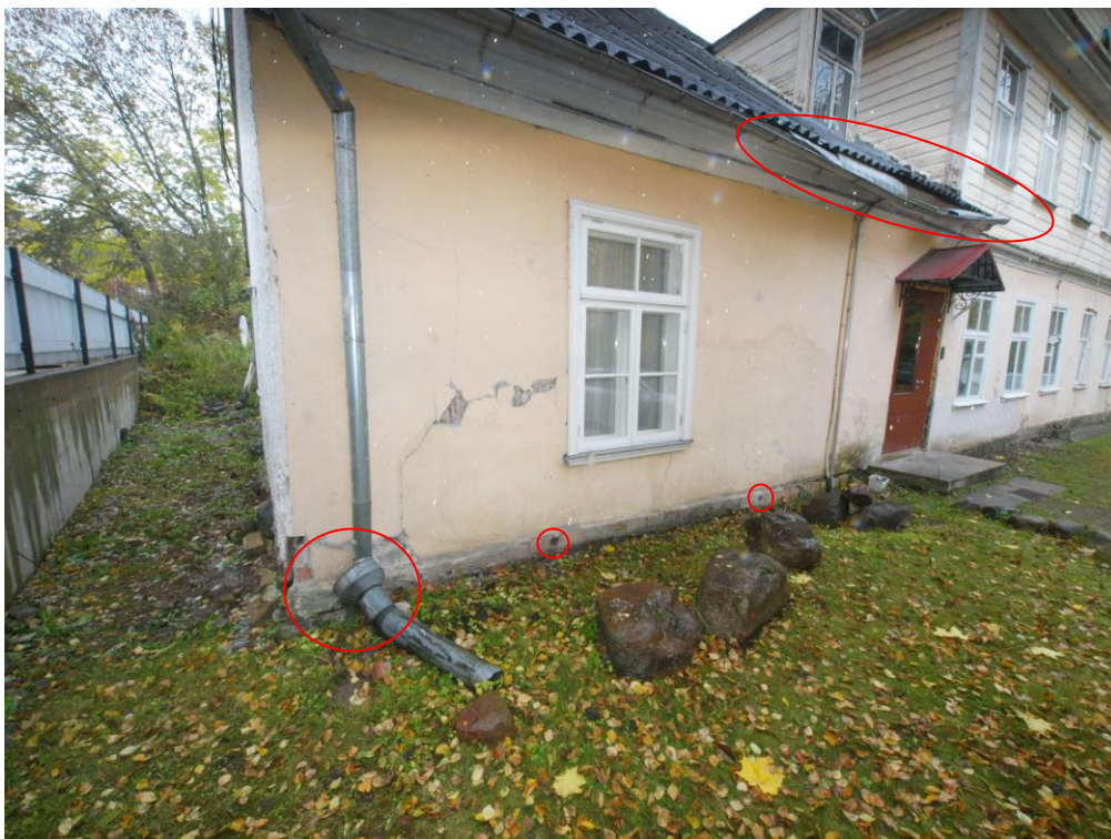
Foto 1. Amortiseerunud vihmaveesüsteem ja liiga väikesed ventilatsiooniavad
