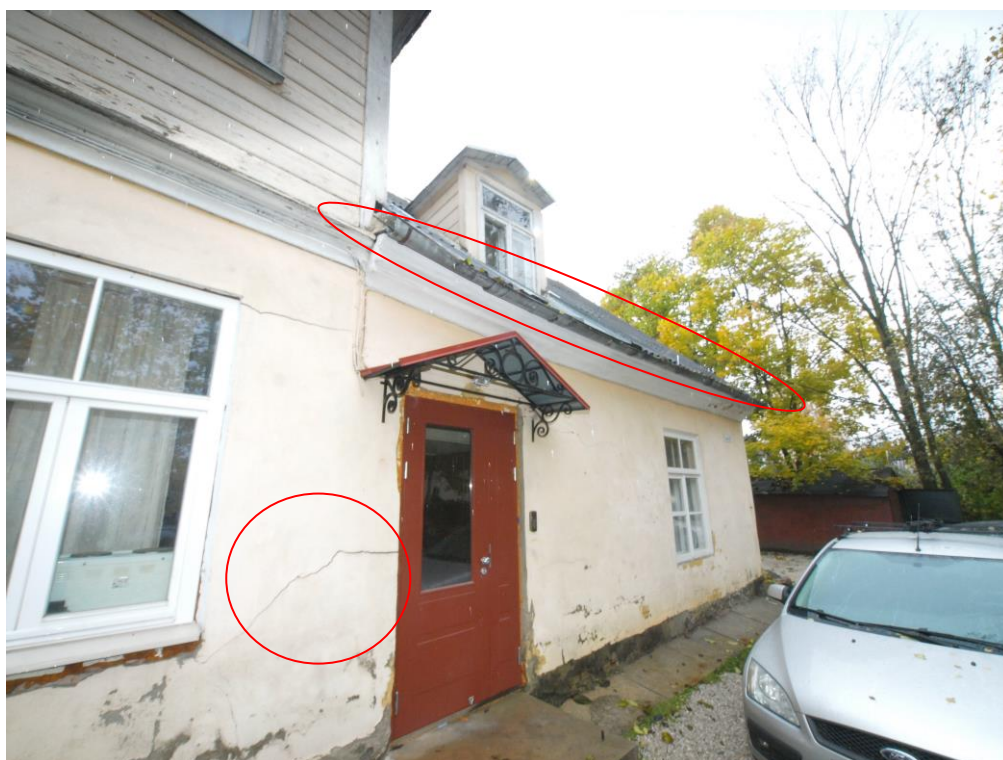
Foto 5. Amortiseerunud vihmaveesüsteem, vajumisest tingitud pragu seinas
