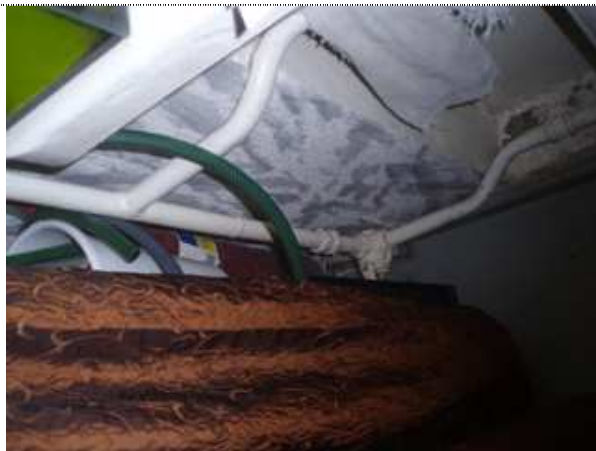
Tüüpiline radiaatori ühendusviis hoones
