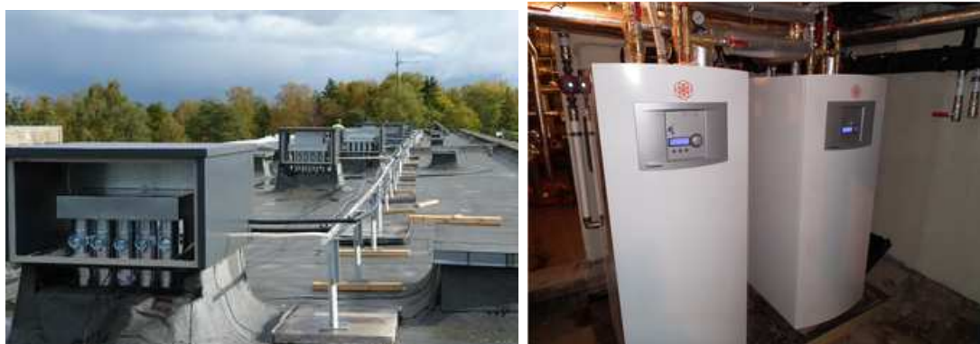
Pilt 3. Terve maja soojustagastusega ventilatsiooni süsteem. Tagastatud soojus kasutatakse soojavee valmistamiseks.
