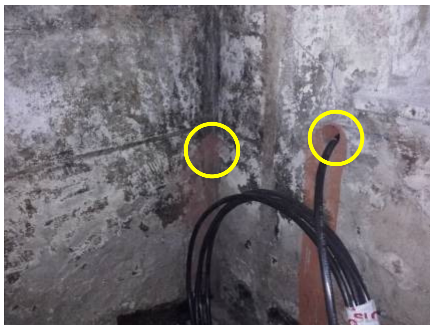
Uus ol.olev 0,4kV kaabelliin liitumiskilbist. Läbiviigud läbi seinte olemas.
